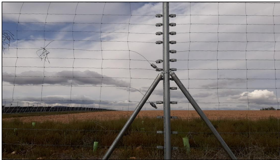
Figura 35: Empalmes del vallado con algunos tensores rotos detectados en la PSFV
