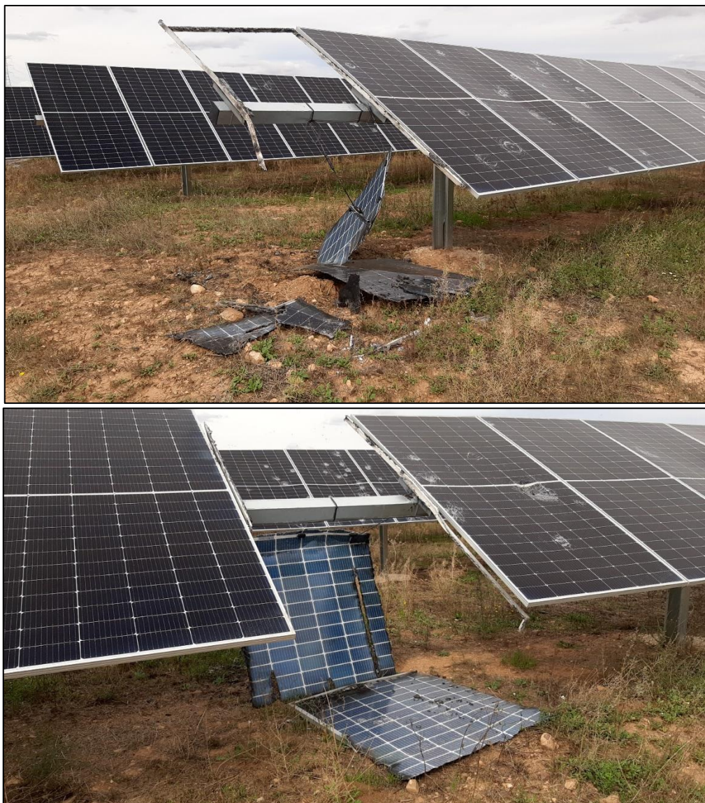
Figura 45: Paneles solares afectados por incendios en los meses de agosto y septiembre
