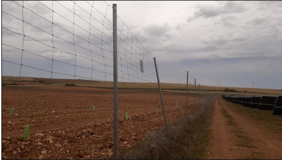
Figura 37: Poste ligeramente inclinado en la cara norte el vallado de la PSFV
