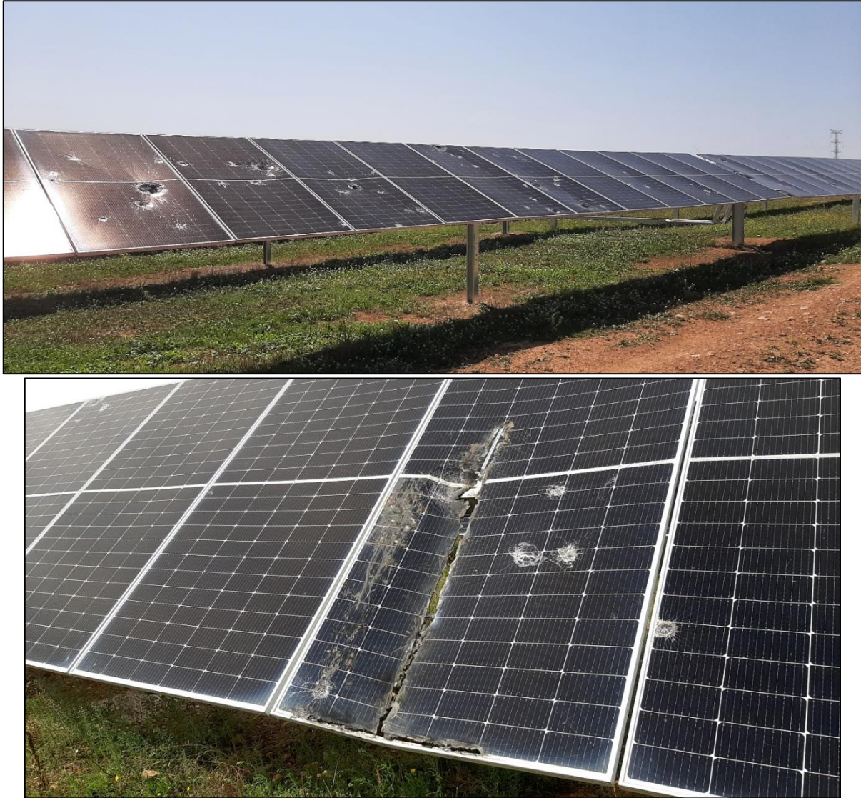
Figura 41: Daños provocados por el granizo en los paneles solares
