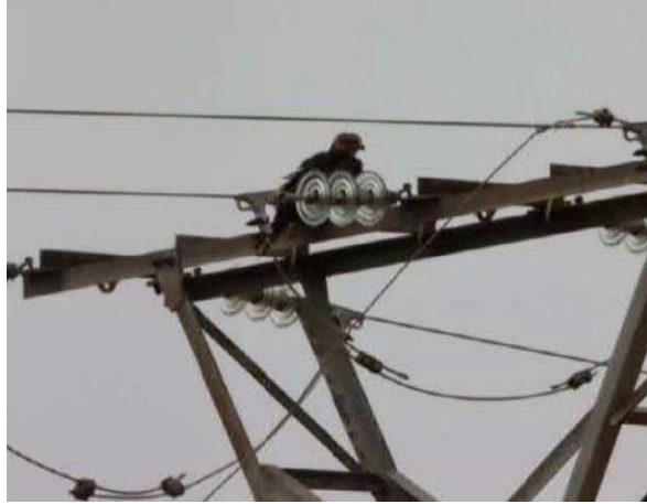
Imagen 8. Milano negro posado en uno de los apoyos de la LAAT de evacuación de las plantas fotovoltaicas
