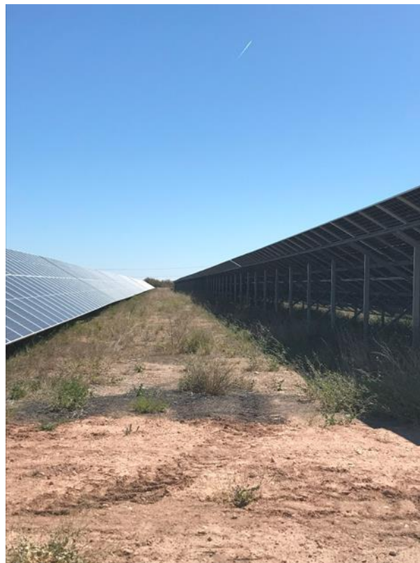
Figura 14: Vegetación natural entre paneles.
