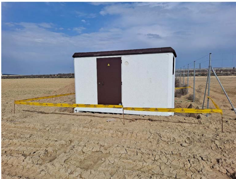
Figura 4.1. Caseta ubicada en el extremo occidental de la planta “San Pedro B” y que albergará un centro de transformación
