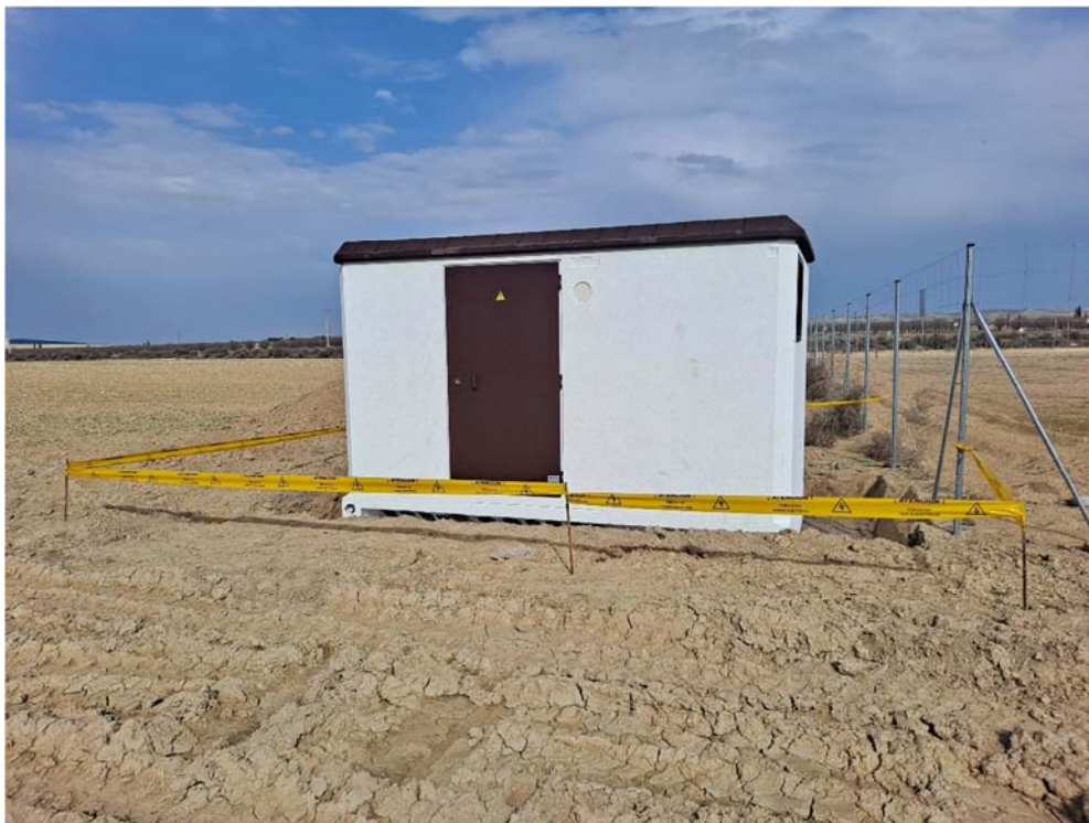
Figura 8.1. Caseta prefabricada donde se instalará un centro de transformación, junto al recinto de “San Pedro B”
