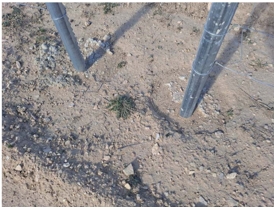
Figura 8.2. Alambres en el suelo en los pasos de fauna, identificados a fecha 8-11-23 en los dos recintos de la planta
