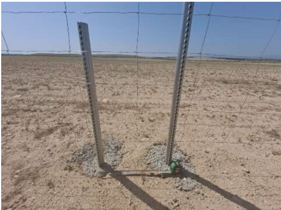
Figura 8.7. Paso para fauna en el vallado pendiente de abrir en recinto San Pedro A
