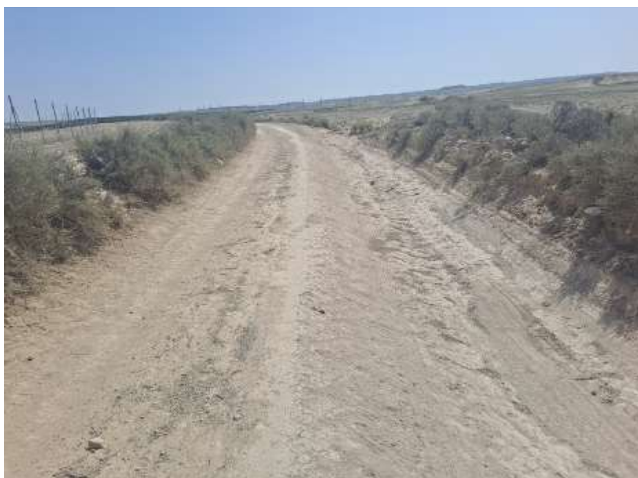
Figura 8.4. Estado del camino que discurre junto a la planta. Presenta alguna zona algo hundida, si bien no se debe a las obras en la planta. No presenta obstáculos.
