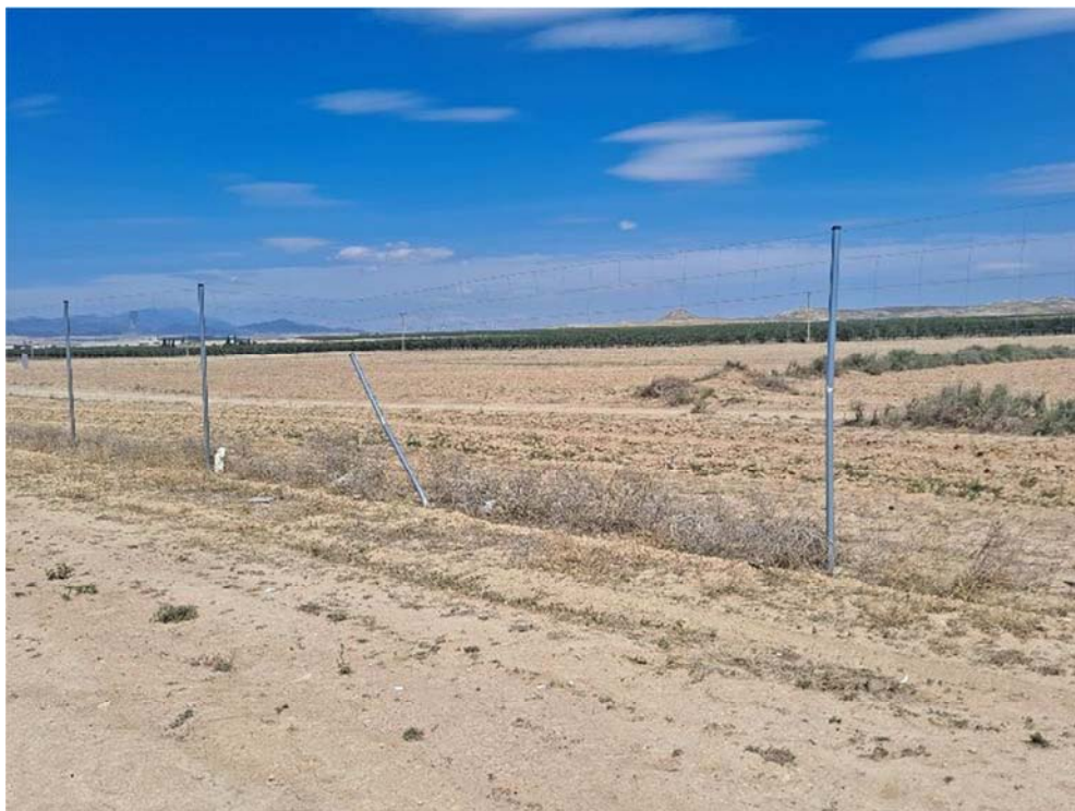
Figura 8.12. Poste doblado y placas de visibilidad caídas/ausentes. El vallado se encuentra roto y con elementos punzantes
