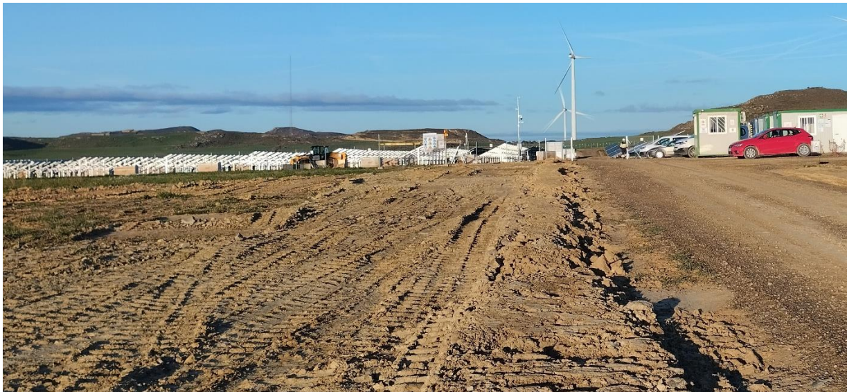
Zanja de conexión planta-SET, paralela al vial de acceso a la planta, ejecutada y tapada, a falta sólo de la restauración morfológica final
