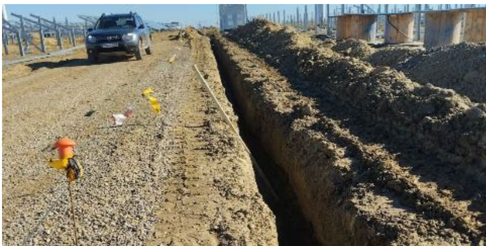
Zanja entre los CT de la planta, con maderas colocadas para la salida de animales
