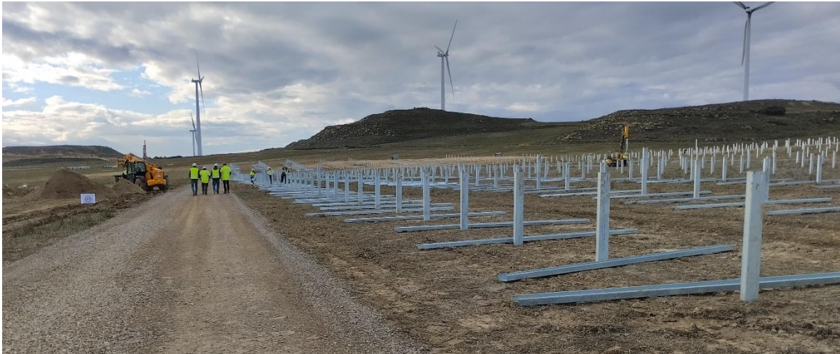
Avance de los trabajos de hinca: ya casi ejecutadas todas las de la mitad norte de la planta, el 07-11-23.
