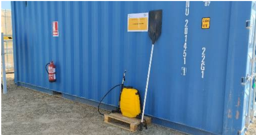
Elementos contra incendios en obra, a finales de septiembre de 2023
