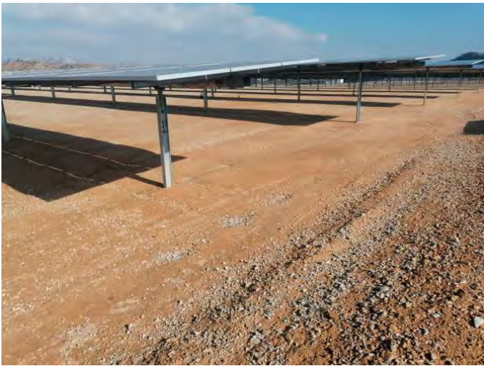
Fotografía 09.- Estado del suelo en bloques de construcción reciente. Cubierta vegetal escasa. Enero.
