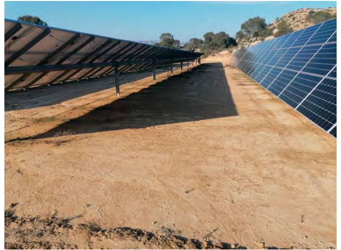
Fotografía 08.- Estado del suelo en bloques de construcción reciente. Cubierta vegetal rala y escasa. Enero.
