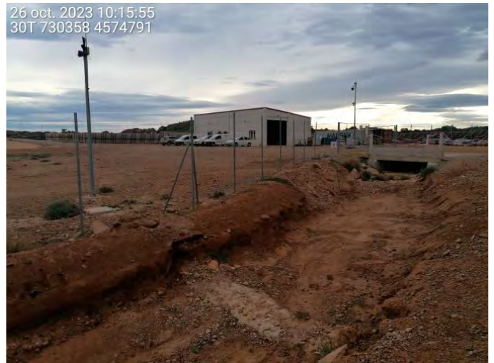
Fotografía 12.- Procesos erosivos. Estado de la cuneta reparada junto al puente de acceso a la planta. Octubre.
