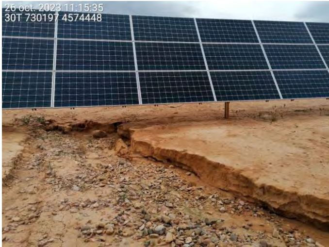
Fotografía 13. - Procesos erosivos. Cárcavas y arrastres bajo seguidores debidas a lluvias torrenciales. Octubre.
