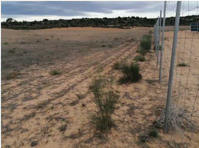
Fotografía 21.- Estado de la pantalla perimetral: Vallado del extremo sur, semi-perímetro Oeste. Octubre.
