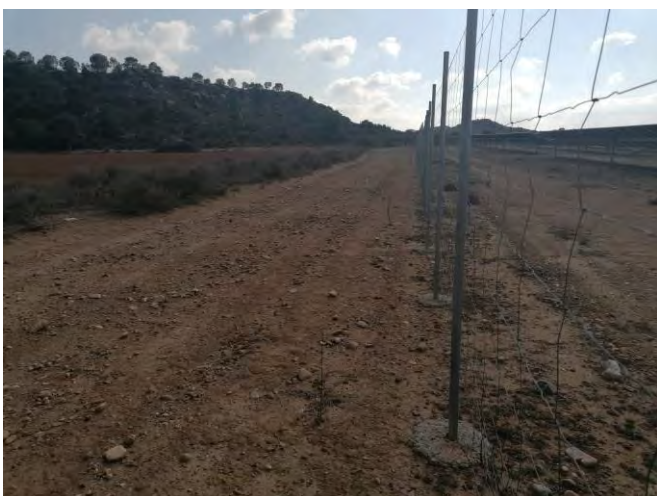
Fotografía 29.- Estado de la pantalla perimetral, lado Este (semi-recinto Este), pantalla visual en el tramo próximo al Camino Natural del Ebro (GR-99). Enero.
