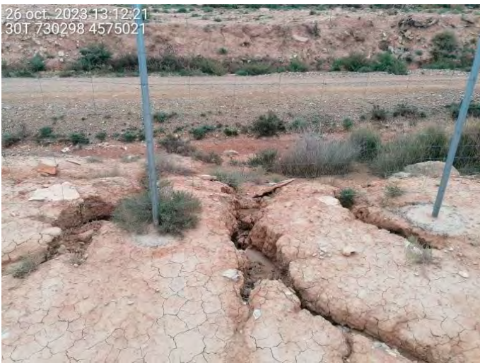
Fotografía 11.- Procesos erosivos. Cárcavas y arrastres bajo el vallado debidas a lluvias torrenciales. Octubre.
