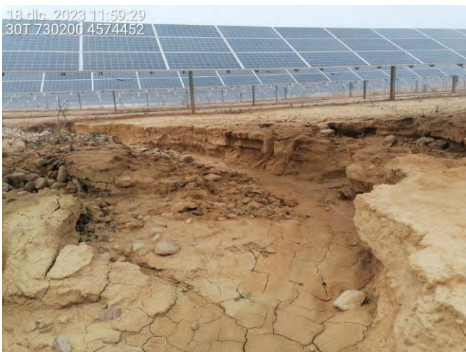
Fotografía 17. - Procesos erosivos. Cárcavas y arrastres bajo seguidores debidas a lluvias torrenciales. Diciembre.
