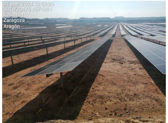
Fotografía 10.- Estado del suelo en bloques de construcción reciente. Cubierta vegetal escasa. Enero.
