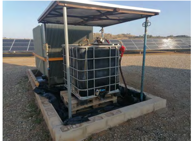
Fotografía 38.- Depósito de gasoil techado y con suelo impermeable. con bordes altos a modo de bandeja y aislado con plástico). Enero.
