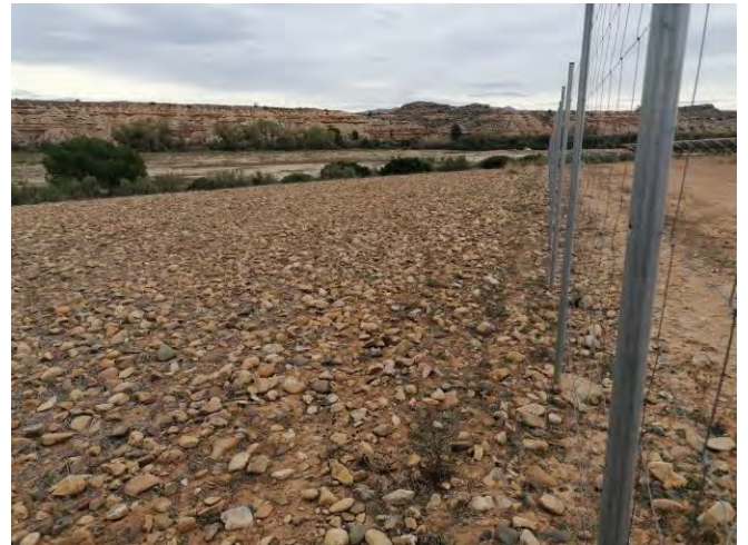
Fotografía 22.- Estado de la pantalla perimetral: Vallado del extremo norte, semi-perímetro Oeste. Octubre.
