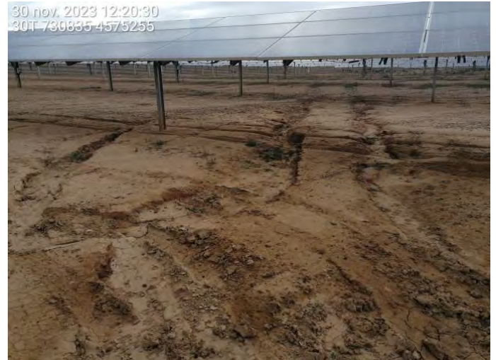
Fotografía 14. - Erosión. Inicio de cárcavas y arrastres bajo seguidores. Noviembre.
