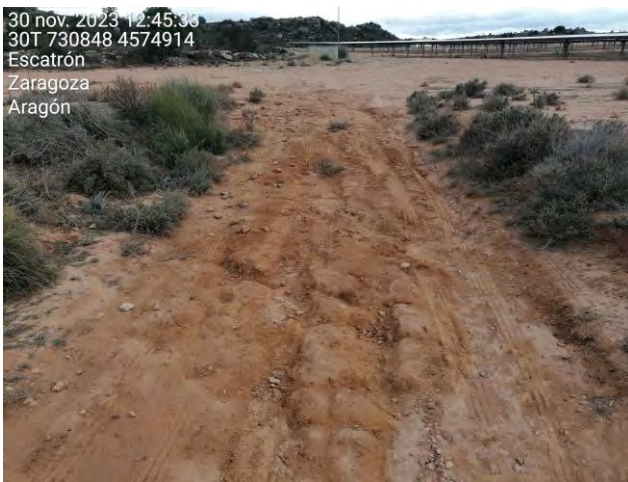
Fotografía 15. - Erosión. Inicio de cárcavas y arrastres en caminos. Noviembre.
