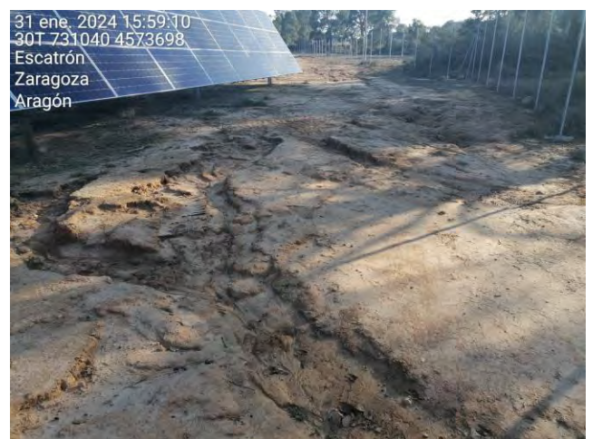
Fotografía 18. - Procesos erosivos. Cárcavas y arrastres bajo seguidores debidas a lluvias torrenciales. Enero.
