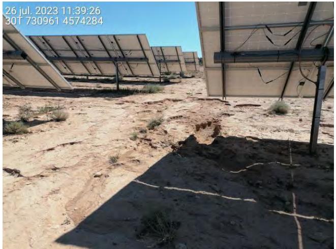
Fotografía 28.- Procesos erosivos. Inicio de cárcavas por lluvias torrenciales.
