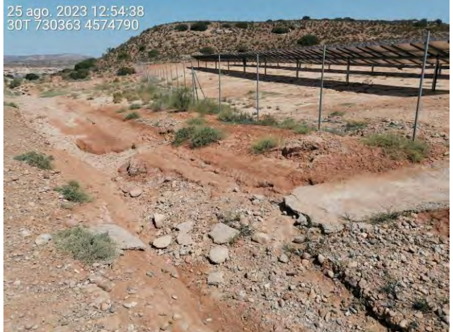
Fotografía 26.- Procesos erosivos. Estado de la cuneta junto alpuente de acceso en la pista central tras las últimas tormentas.
