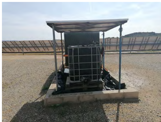
Fotografía 35.- Depósito de gasoil techado y con suelo impermeable (con bordes altos a modo de bandeja y aislado con plástico).
