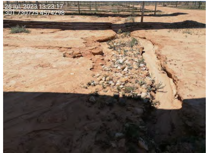
Fotografía 32.- Procesos erosivos. Inicio de cárcavas por lluvias torrenciales.
