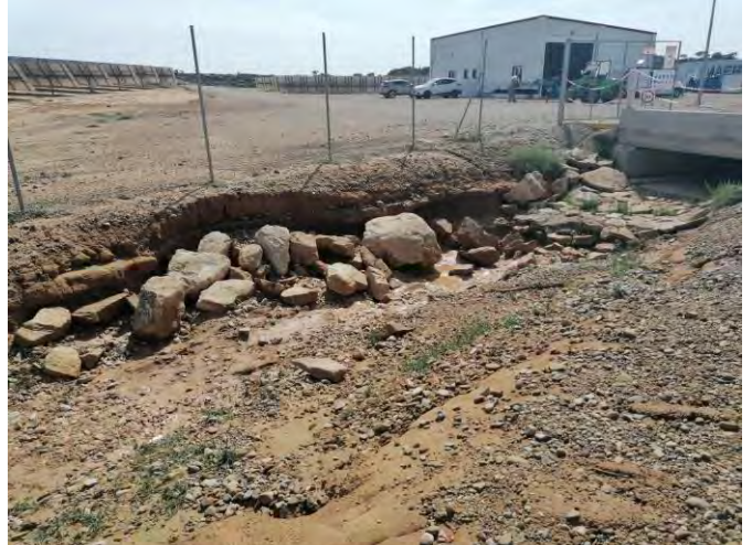
Fotografía 26.- Procesos erosivos. Estado de la cuneta de la pista central tras las últimas tormentas
