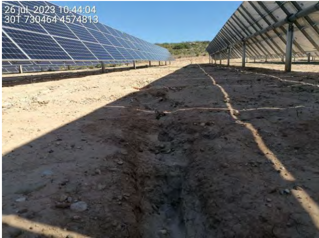
Fotografía 25.- Procesos erosivos. Inicio de cárcavas por lluvias torrenciales.
