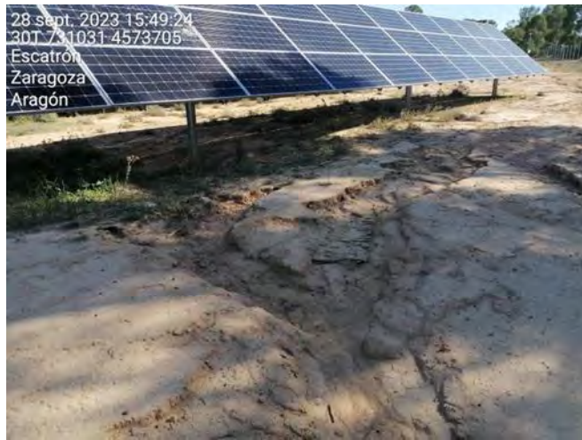
Fotografía 51.- Procesos erosivos. Inicio de cárcavas y arrastres en caminos.
