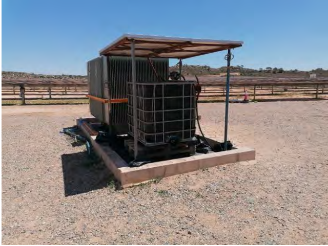
Fotografía 19.- Depósito de gasoil techado y con suelo impermeable (con bordes altos a modo de bandeja y aislado conplástico).
