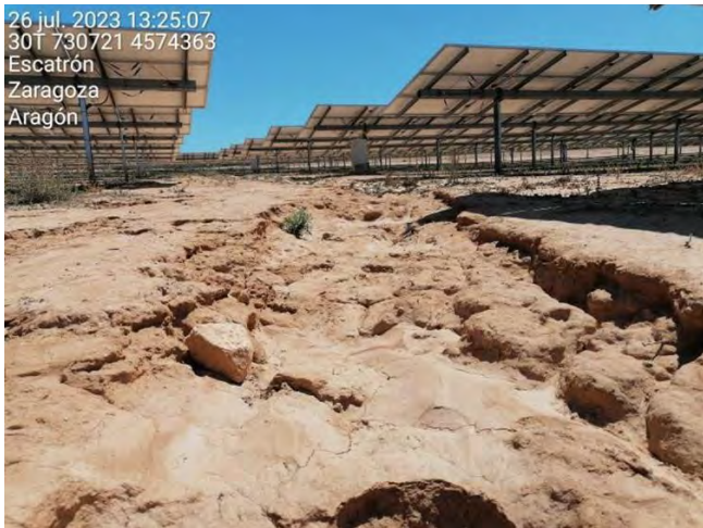
Fotografía 33.- Procesos erosivos. Inicio de cárcavas por lluvias torrenciales.
