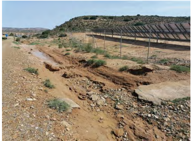
Fotografía 28.- Procesos erosivos. Estado de la cuneta de la pista central tras las últimas tormentas.
