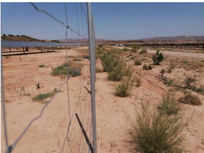
Fotografía 17.- Estado de la pantalla perimetral: Vallado de la pista central, semi-perímetro Oeste.
