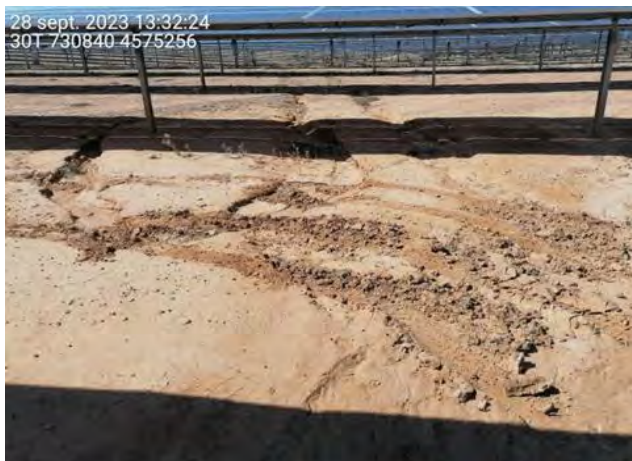
Fotografía 41.- Erosión. Inicio de cárcavas y arrastres bajo seguidores.
