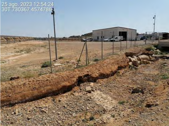
Fotografía 25.- Procesos erosivos. Estado de la cuneta junto alpuente de acceso en la pista central tras las últimas tormentas.
