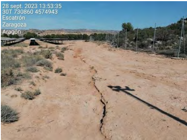
Fotografía 47.- Procesos erosivos. Inicio de cárcavas y arrastres en caminos.
