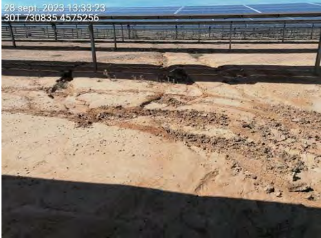
Fotografía 43.- Procesos erosivos. Inicio de cárcavas y arrastres bajo seguidores.
