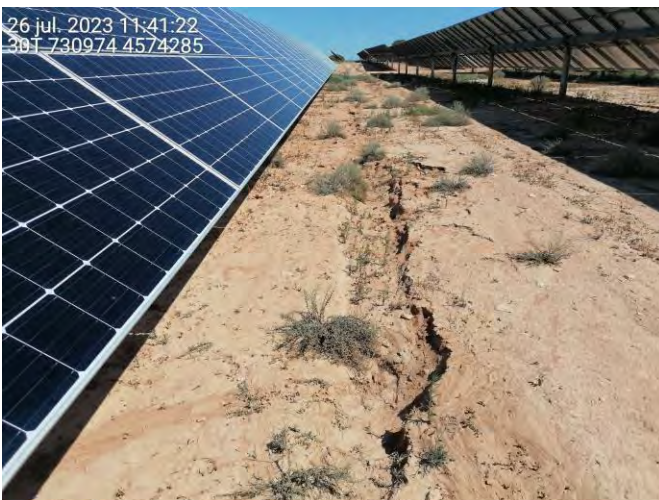
Fotografía 29.- Procesos erosivos. Inicio de cárcavas por lluvias torrenciales.
