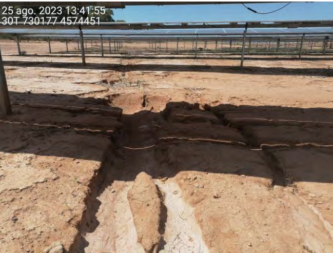
Fotografía 29.- Procesos erosivos. Inicio de cárcavas por lluvias torrenciales.
