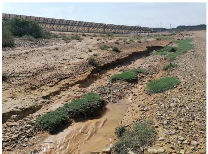
Fotografía 30.- Procesos erosivos. Estado de la cuneta de la pista central tras las últimas tormentas.
