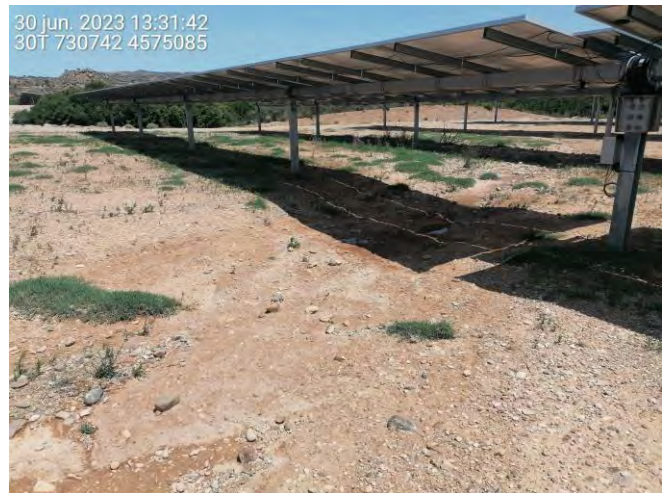
Fotografía 10. - Procesos erosivos. Cárcavas y arrastres bajo seguidores.
