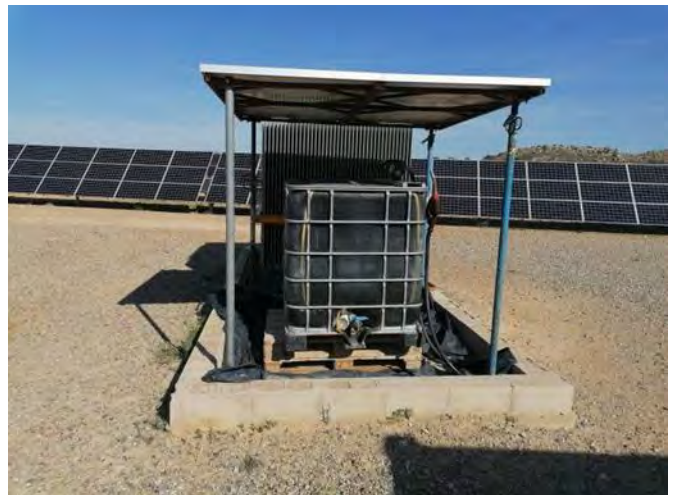
Fotografía 34. - Depósito de gasoil techado y con suelo impermeable (con bordes altos a modo de bandeja y aislado con plástico).
