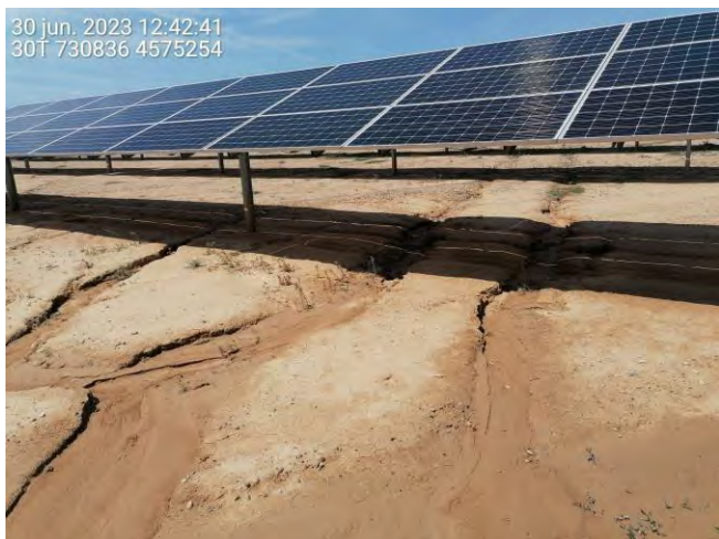
Fotografía 11. - Procesos erosivos. Cárcavas y arrastres bajo seguidores.
