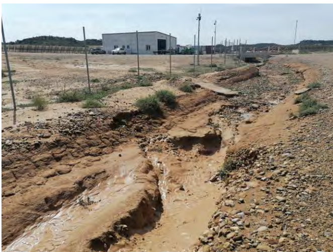
Fotografía 29.- Procesos erosivos. Estado de la cuneta de la pista central tras las últimas tormentas.
