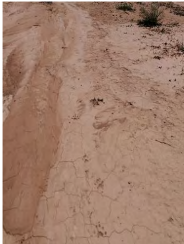
Fotografía 15.- Procesos erosivos. Cárcavas y arrastres bajo seguidores.
