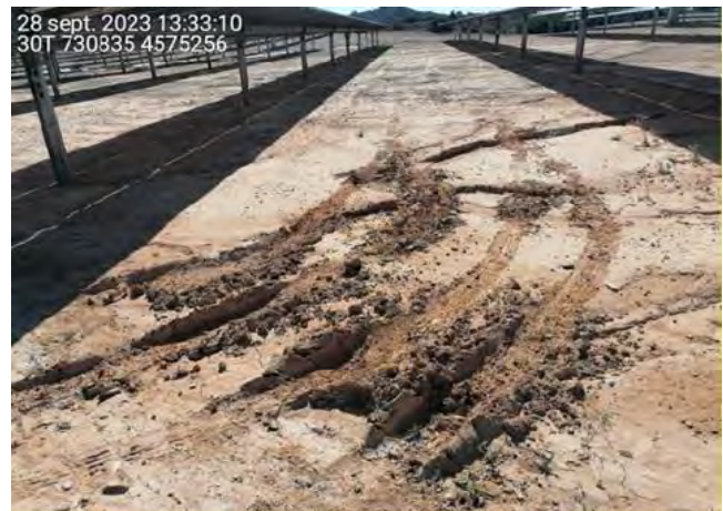
Fotografía 42.- Erosión. Inicio de cárcavas y arrastres bajo seguidores.
