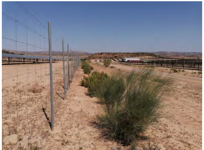
Fotografía 16.- Estado de la pantalla perimetral: Vallado de la pista central, semi-perímetro Oeste.
