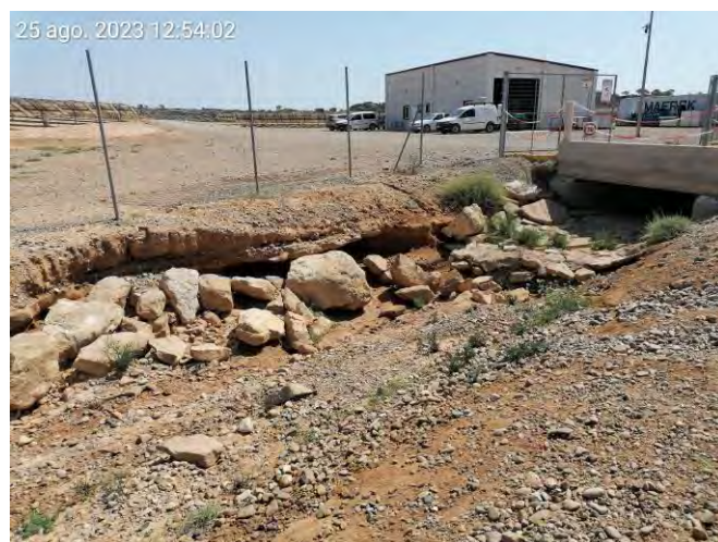
Fotografía 24.- Procesos erosivos. Estado de la cuneta junto alpuente de acceso en la pista central tras las últimas tormentas.
