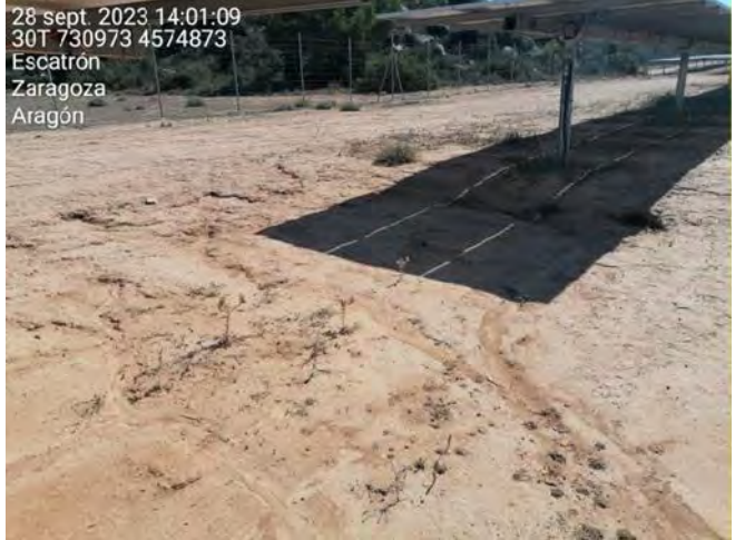
Fotografía 44.- Procesos erosivos. Erosión. Inicio de cárcavas y arrastres bajo seguidores.
