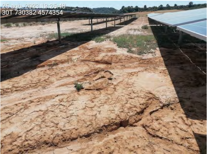
Fotografía 30.- Procesos erosivos. Inicio de cárcavas por lluvias torrenciales.
