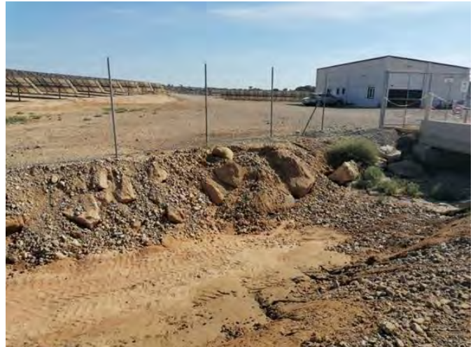
Fotografía 38.- Procesos erosivos. Reparación de cuneta junto a puente de acceso a la planta.
