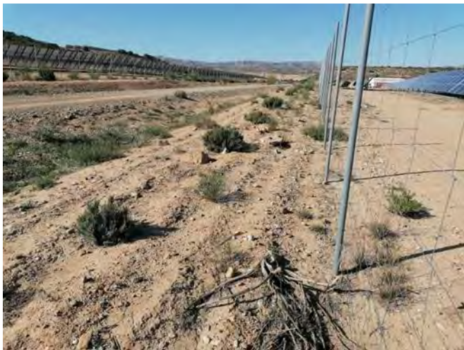
Fotografía 33. - Estado de la pantalla perimetral en torno a la pista central (semi-recinto Este).
