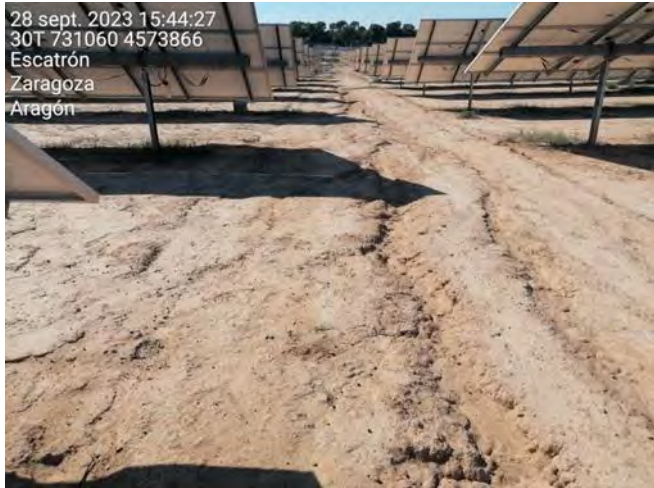
Fotografía 49.- Procesos erosivos. Inicio de cárcavas y arrastres en caminos.
