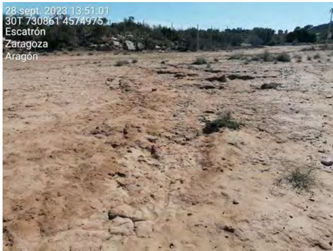
Fotografía 45.- Procesos erosivos. Inicio de cárcavas y arrastres en caminos.
