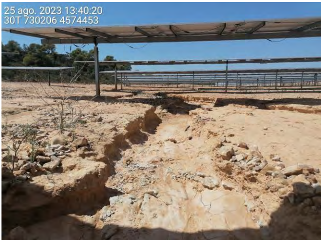
Fotografía 27.- Procesos erosivos. Inicio de cárcavas por lluvias torrenciales.
