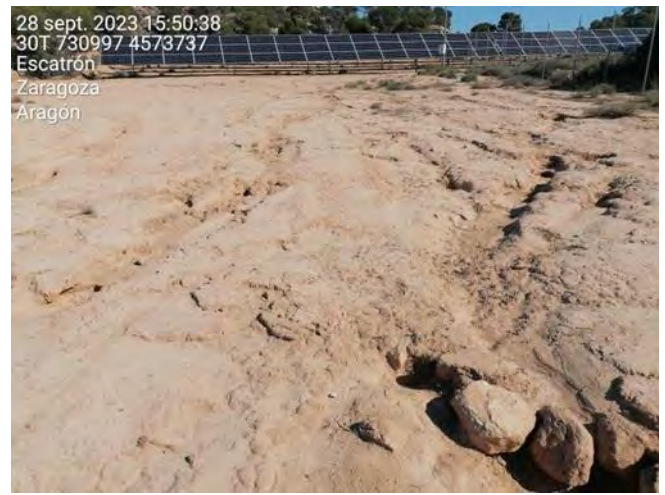
Fotografía 52.- Procesos erosivos. Inicio de cárcavas y arrastres en caminos.
