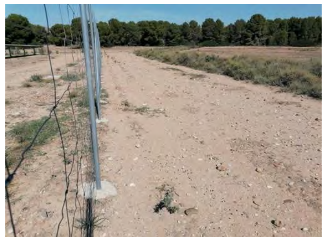
Fotografía 30.- Estado de la pantalla perimetral, lado Este (semi-recinto Este), pantalla visual en el tramo próximo al Camino Natural del Ebro (GR-99).
