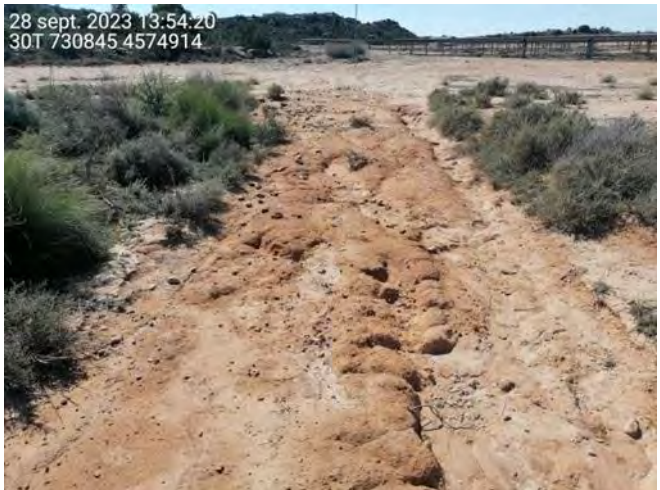
Fotografía 48.- Procesos erosivos. Inicio de cárcavas y arrastres en caminos.
