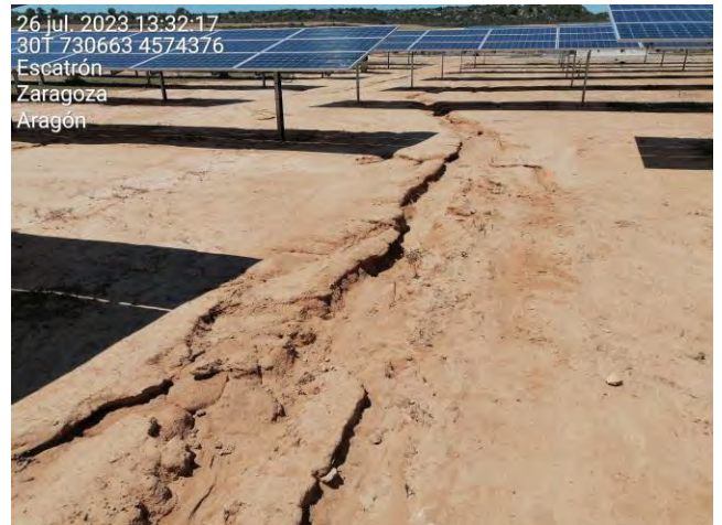
Fotografía 35.- Procesos erosivos. Cárcavas y arrastres bajoseguidores.
