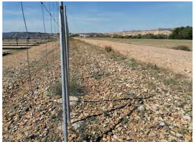
Fotografía 28.- Estado de la pantalla perimetral, lado Norte (semi-recinto Este), pantalla visual en el tramo próximo al Camino Natural del Ebro (GR-99).
