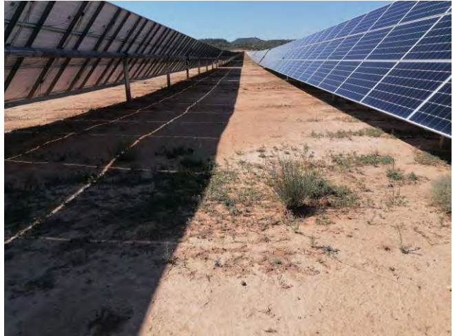
Fotografía 02.- Estado del suelo en bloques de construcción reciente. Cubierta vegetal rala y escasa.
