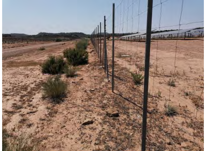
Fotografía 14.- Estado de la pantalla perimetral: Vallado de la pista central, semi-perímetro Oeste.
