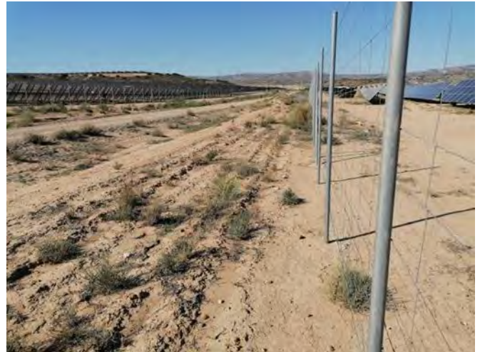
Fotografía 32. - Estado de la pantalla perimetral en torno a la pista central (semi-recinto Este).
