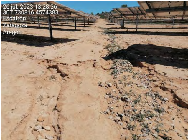
Fotografía 35.- Procesos erosivos. Cárcavas y arrastres bajoseguidores.
