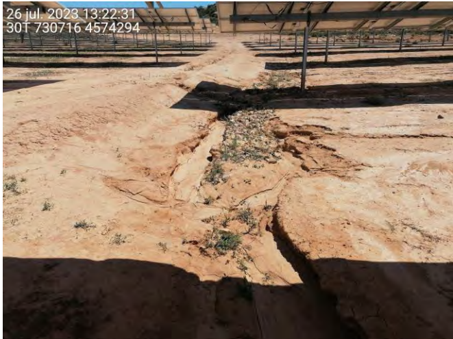
Fotografía 31.- Procesos erosivos. Inicio de cárcavas por lluvias torrenciales.
