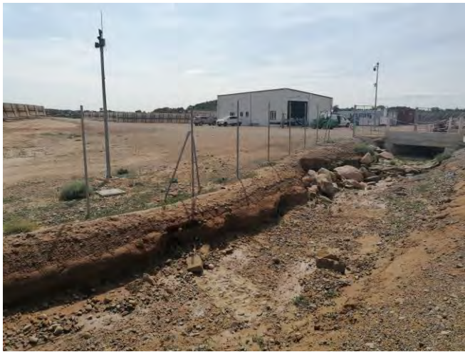
Fotografía 27.- Procesos erosivos. Estado de la cuneta de la pista central tras las últimas tormentas.
