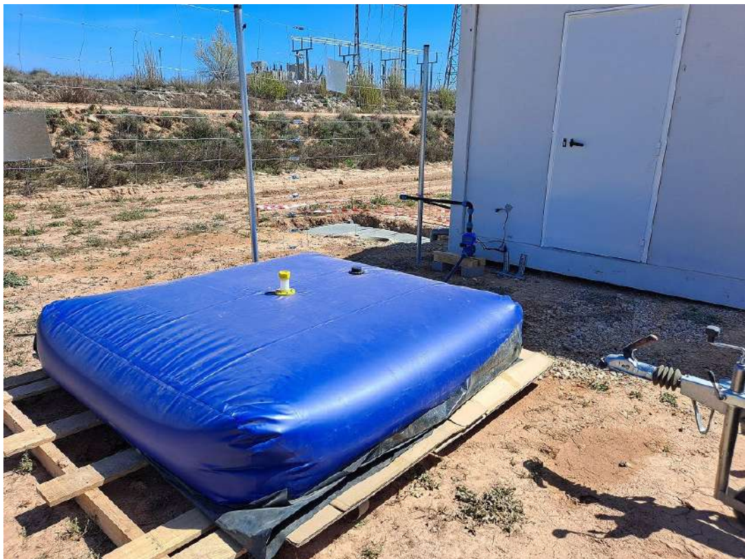
Figura 9. Fosa séptica instalada en PITARCO
