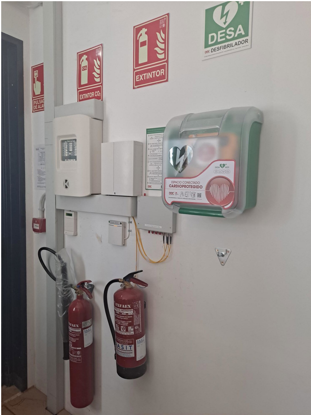
Fotografía 3. Medidas antiincendios y Seguridad y Salud en la subestación PITARCO
