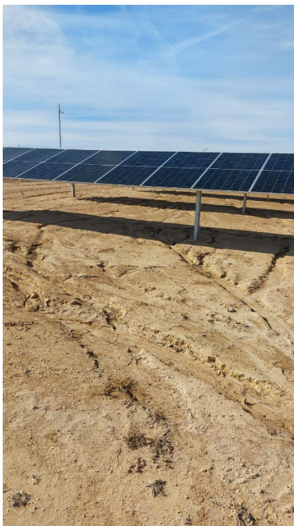
Fotografía 5. Cárcavas y grietas detectadas
