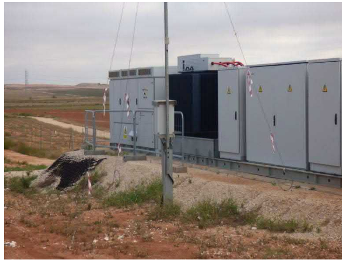
Imagen 5. Tiras de cinta de balizamiento instaladas en los cables de las torres anemométricas.
