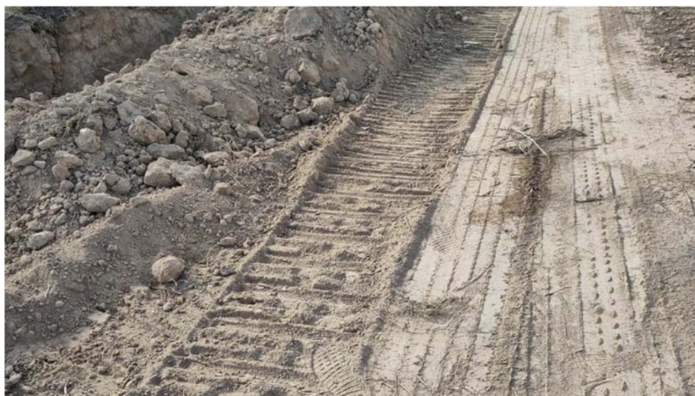
Figura 8.6. Marcas de cadenas de la retroexcavadora que realizó la zanja, sobre la tierra vegetal acopiada
