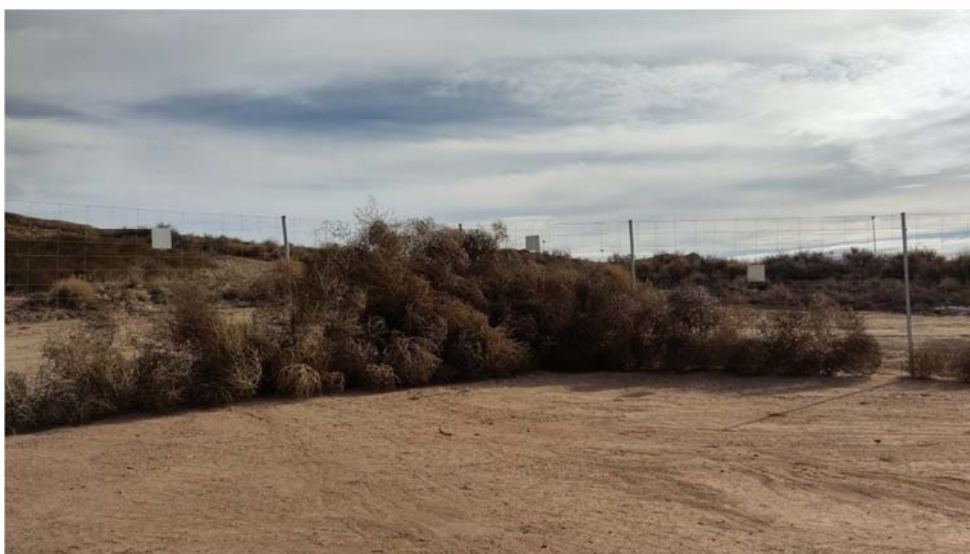
Figura 8.4. Acumulación de vegetación en el vallado como consecuencia del viento
