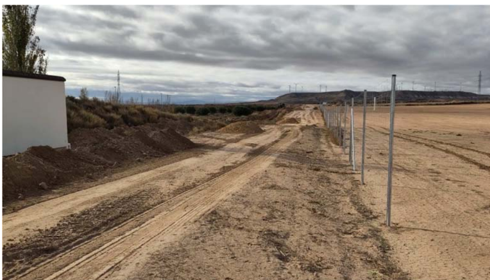
Figura 8.8. Marcas del paso de vehículos y maquinaria sobre los acopios de tierra vegetal. Esta tierra vegetal se encuentra bastante compactada.
