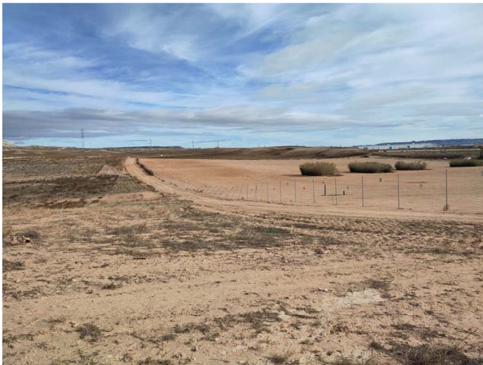
Figura 8.1. Tramo del vallado doblado (extremo norte de la parcela)
