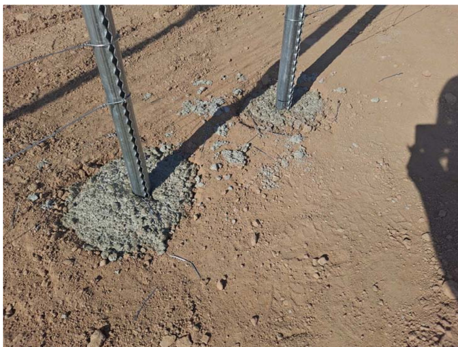
Figura 8.20. Alambres en el suelo que se han observado bajo los pasos de fauna, como consecuencia de su apertura
