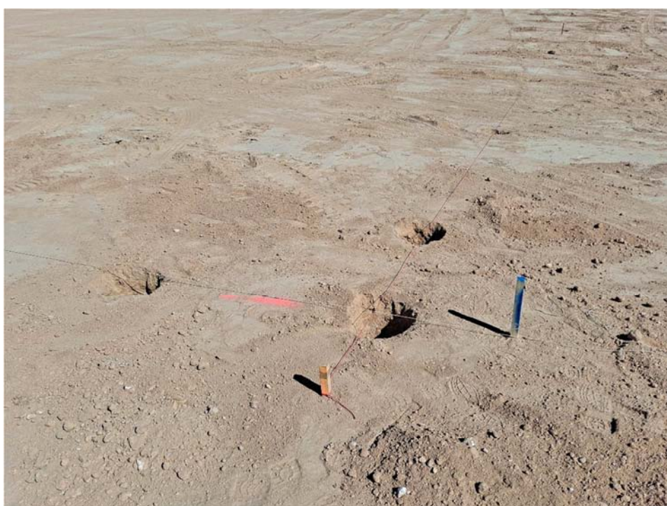
Figura 8.12. Jalonamiento para la instalación del vallado y hoyos para la cimentación de los postes
