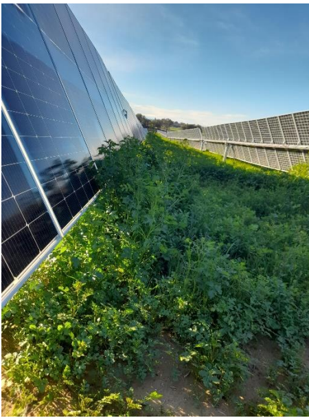
Foto 1. Vegetación crecida por la zona oeste de la planta
