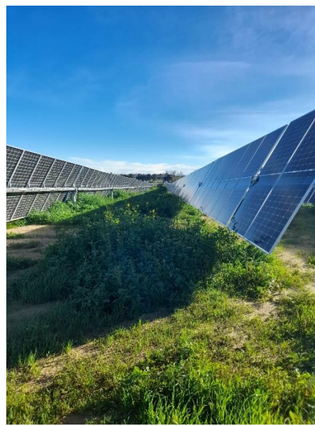
Foto 2. Vegetación crecida por la zona suroeste de la planta
