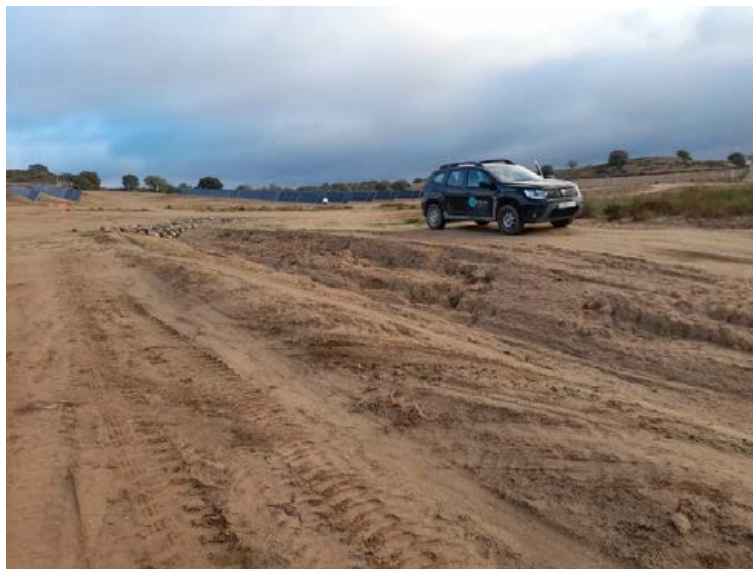
Fig. 4 Erosión en el canal de drenaje central de la parcela
