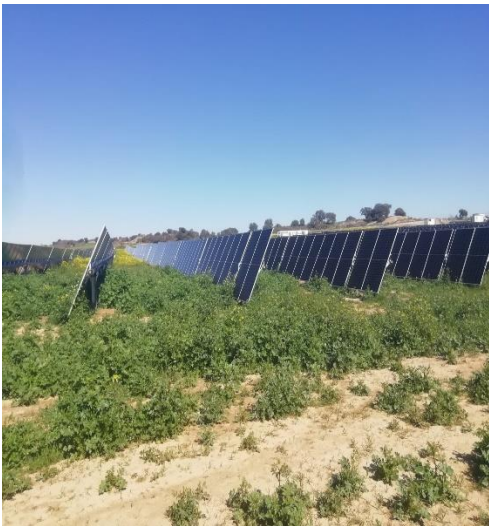
Foto 1. Vegetación crecida por la zona oeste de la planta
