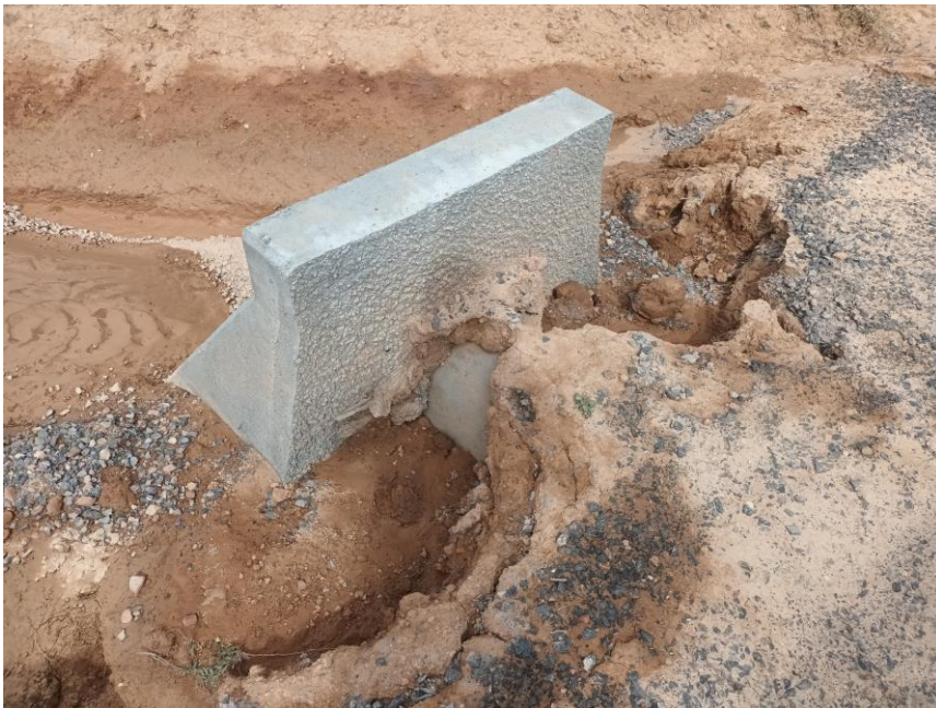
Obra de drenaje transversal (ODT) afectada tras un episodio de lluvias fuertes.
