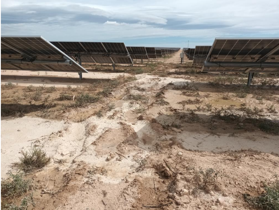
Zona en la que el agua tiende a acumularse dentro del proyecto.
