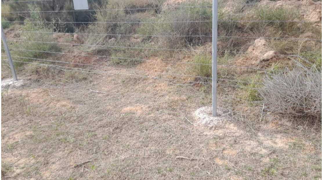
Foto 19. Estado del vallado en zonas puntuales. Entrada de jabalíes a la instalación.
