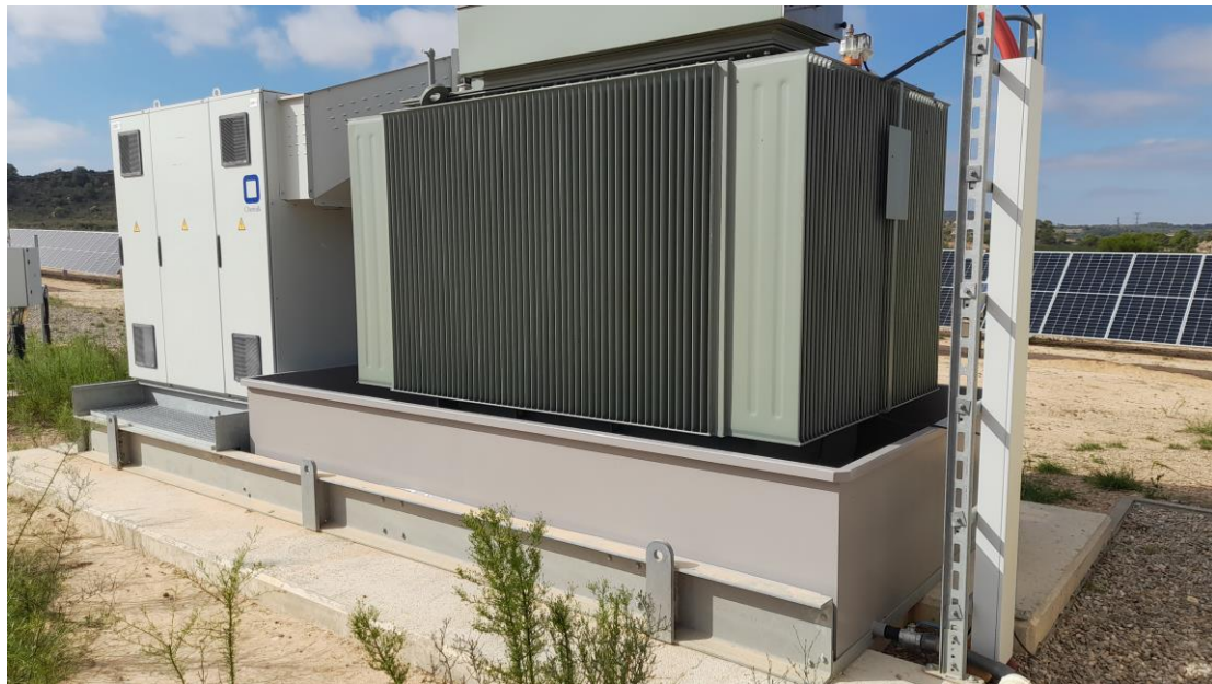
Foto 6. Vista general del transformador de la planta.
