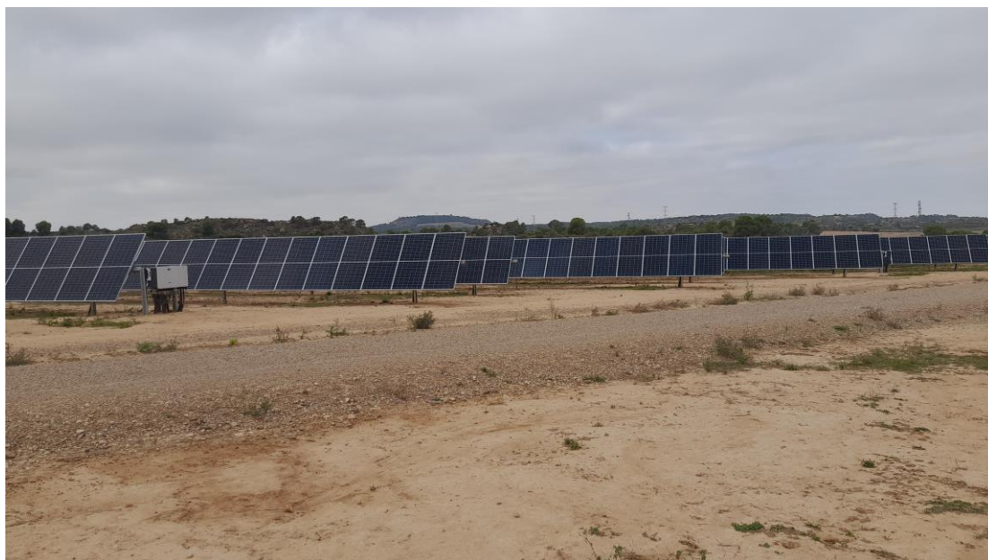
Foto 4. Vista de los paneles fotovoltaicos junto al camino central.
