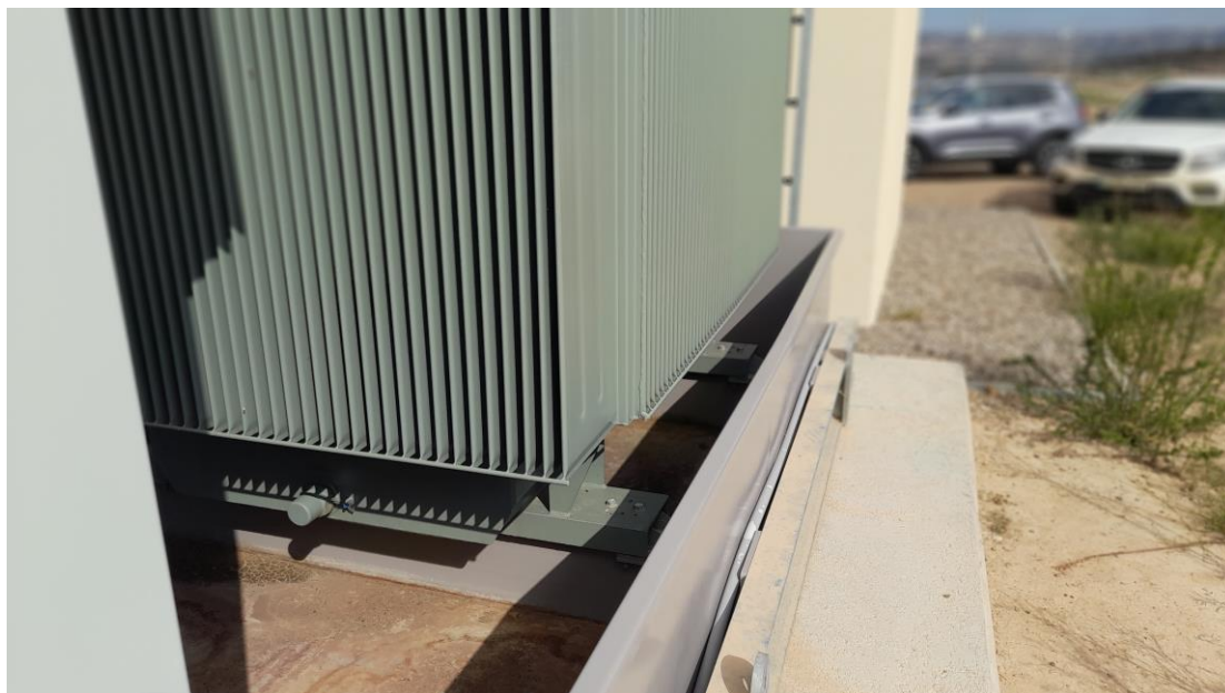
Foto 7. Vista de la cubeta del centro de transformación. Estado limpio y correcto.
