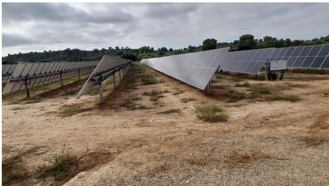
Foto 8. Vista de seguidores y vegetación natural creciendo entre ellos. Situación actual tras un desbroce mediante ganado tres semanas antes (Parte I).
