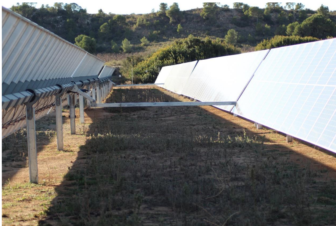
Foto 10. Vista de seguidores y vegetación natural creciendo entre ellos. Situación actual tras sin desbroces durante el trimestre. Diciembre 2023.
