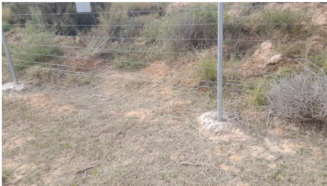
Foto 18. Estado del vallado en zonas puntuales. Entrada de jabalíes a la instalación.
