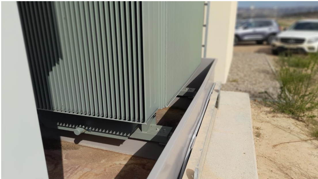
Foto 6. Vista de la cubeta del centro de transformación. Estado limpio y correcto. Septiembre 2023.
