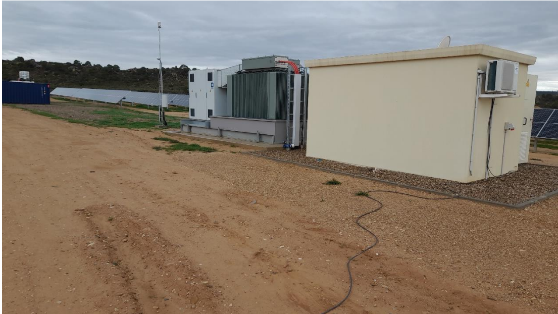
Foto 5. Centro de Transformación y celdas. Marzo 2023.
