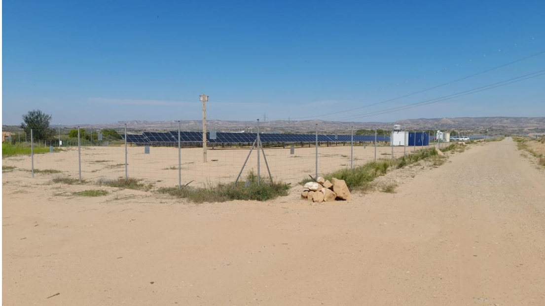
Foto 3. Vista del vallado perimetral de la planta. Apreciación de majano y caja nido. Septiembre 2023.
