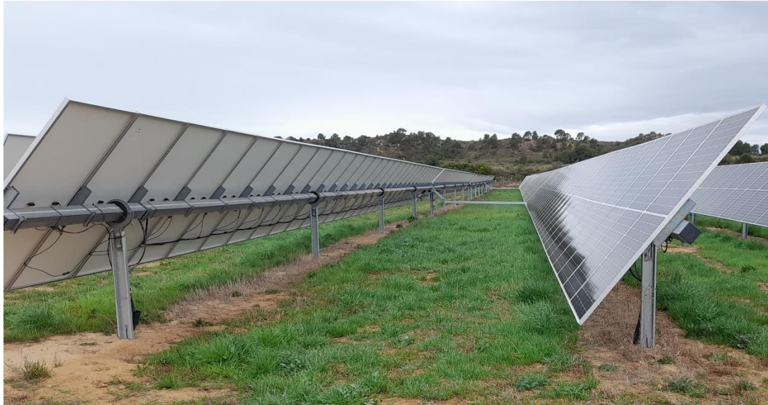
Foto 7. Vista de seguidores y vegetación natural creciendo entre ellos. Marzo 2023.
