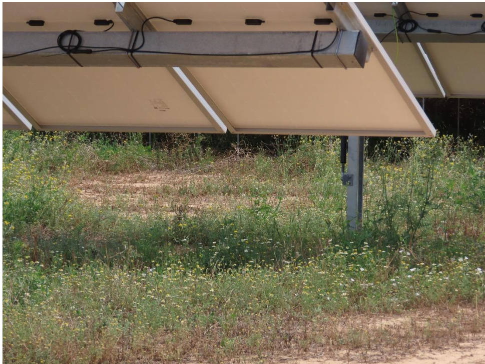
Foto 8. Vista de seguidores y vegetación natural creciendo entre ellos. Junio 2023.
