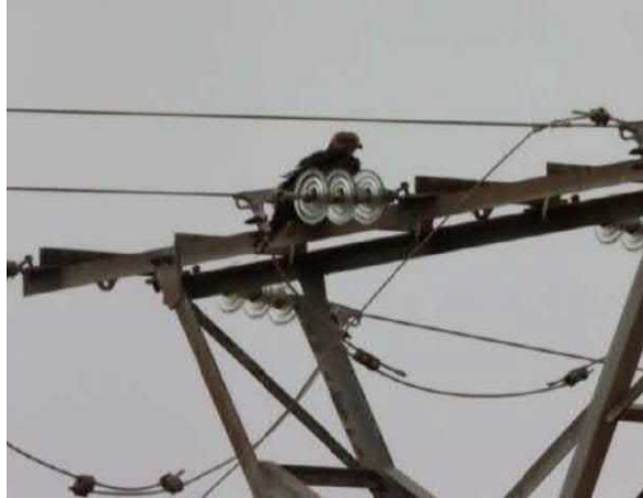
Imagen 9. Milano negro posado en uno de los apoyos de la LAAT de evacuación de las plantas fotovoltaicas
