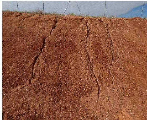
Imagen 1. Procesos erosivos en el talud situado al sur de la planta fotovoltaica de "Híjar I"
