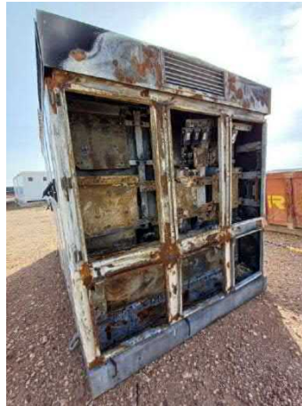
Imagen 22. Centro de transformación incendiado ubicado en el punto limpio
