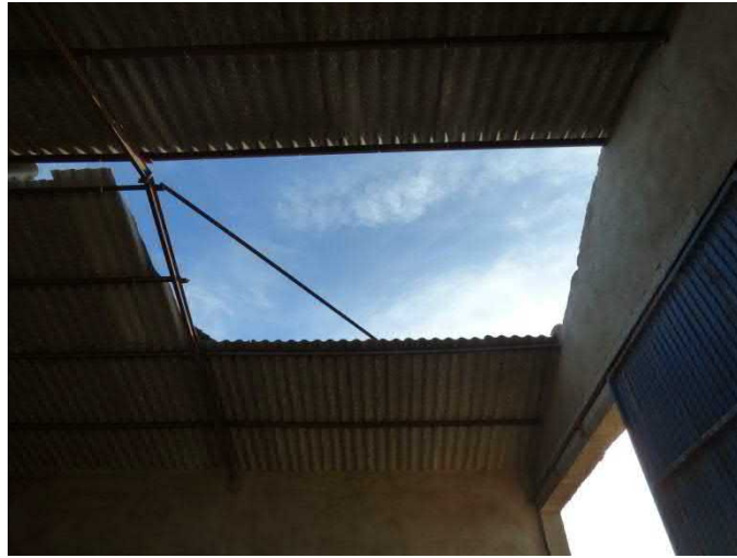
Imagen 12. Estructura del almacén desprovista de tejado debido a las ráfagas de viento.
