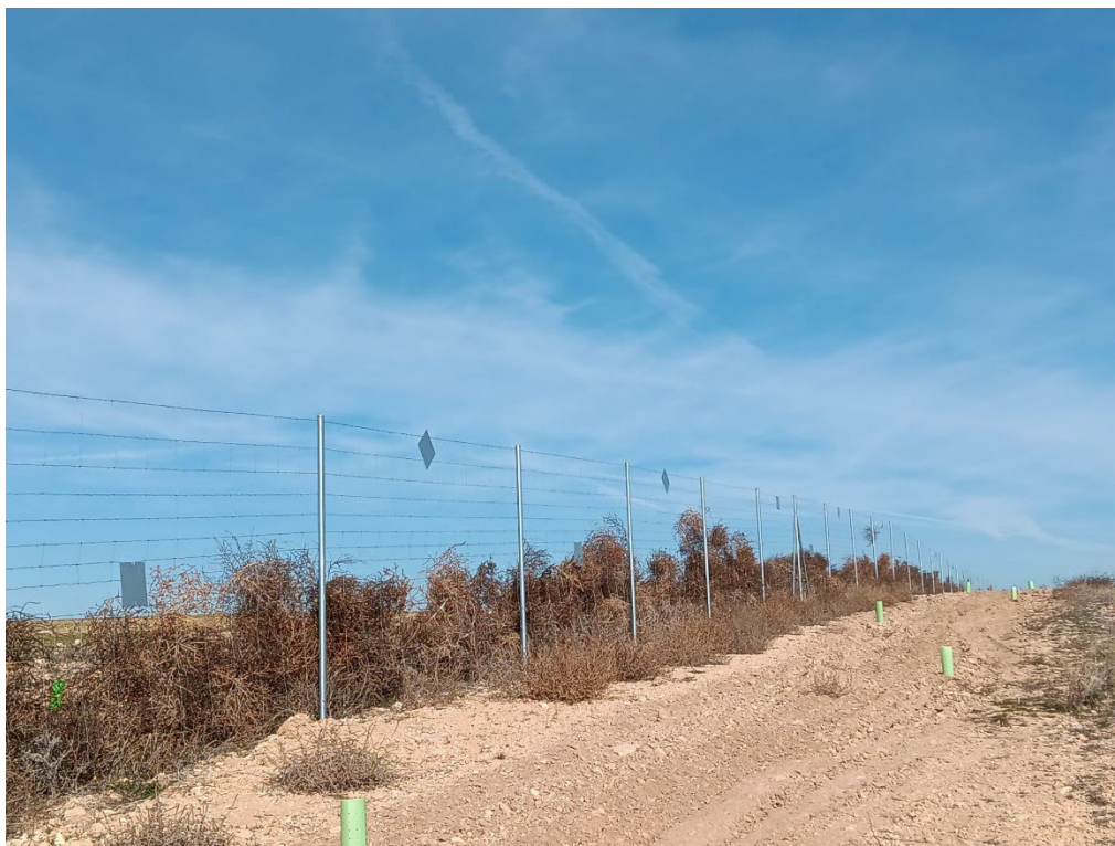
Fig. 1 Estado del vallado con acúmulo de capitanas ( Salsola Kali )
