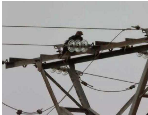
Imagen 9. Milano negro posado en uno de los apoyos de la LAAT de evacuación de las plantas fotovoltaicas
