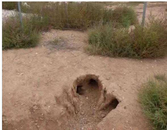
Imagen 16. Madrigueras de conejo bajo los postes del vallado perimetral
