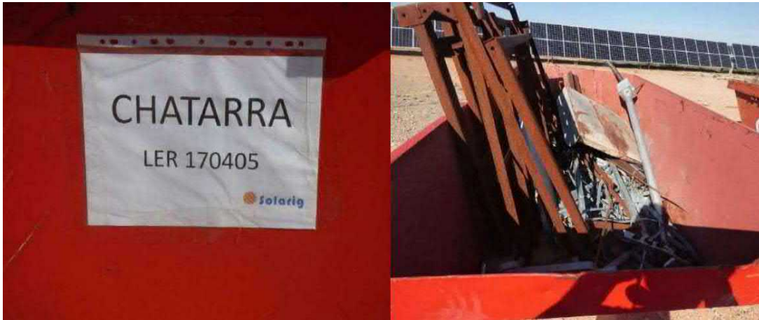
Imagen 22. Contenedor habilitado para el depósito de chatarra adecuadamente identificado
