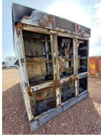
Imagen 21. Centro de transformación incendiado ubicado en el punto limpio
