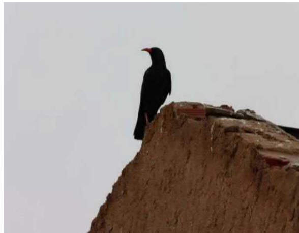
Imagen 13. Ejemplar de chova piquirroja en el almacén tras el hundimiento del tejado
