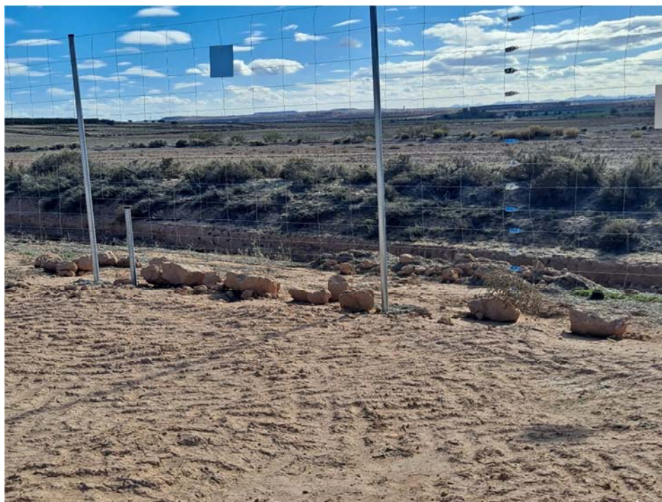
Figura 8.9. Tramo del vallado obstruido por acumulación de rocas
