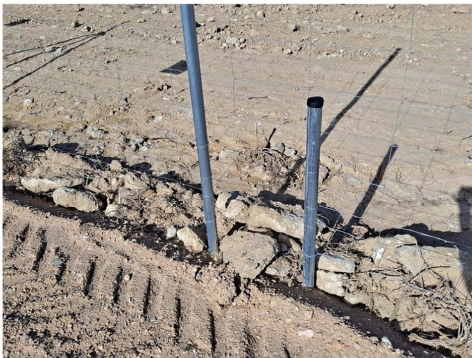
Figura 8.8. Paso de fauna obstruido parcialmente por las tierras procedentes del acondicionamiento del camino exterior
