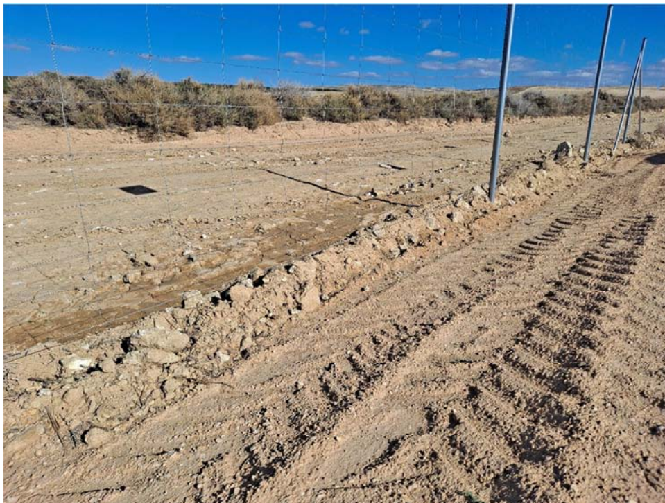
Figura 8.7. Tramo obstruido en la parte inferior del vallado debido a la acumulación de tierras procedentes del acondicionamiento del camino exterior
