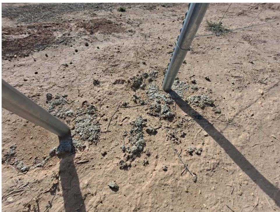
Figura 8.6. Alambres en el suelo identificados en los pasos de fauna del vallado, a fecha 8-11-23
