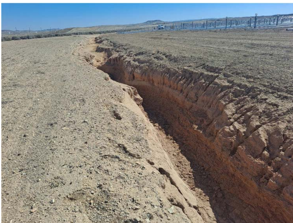
Figura 8.6. Aspecto del barranco que atraviesa la zona de proyecto, con importante incisión
