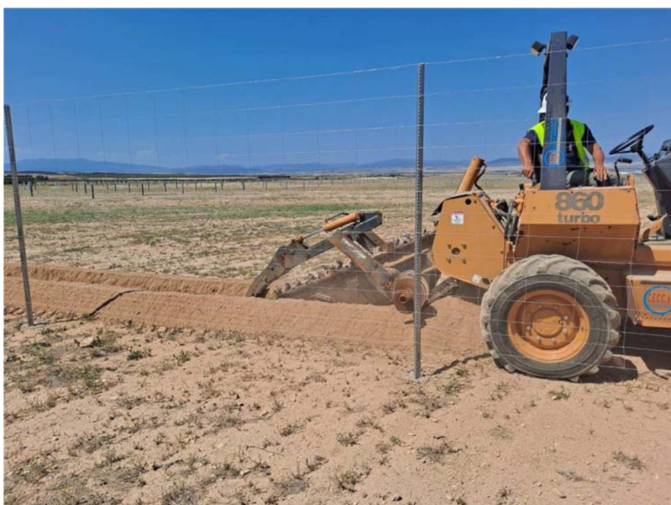
Figura 8.8. Apertura de las zanjas perimetrales para instalación del cableado del sistema de seguridad
