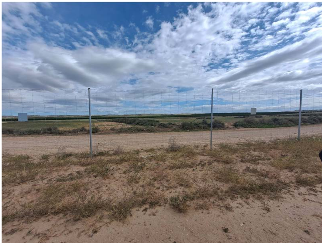
Figura 8.9. Tramo del vallado sin placa de visibilidad
