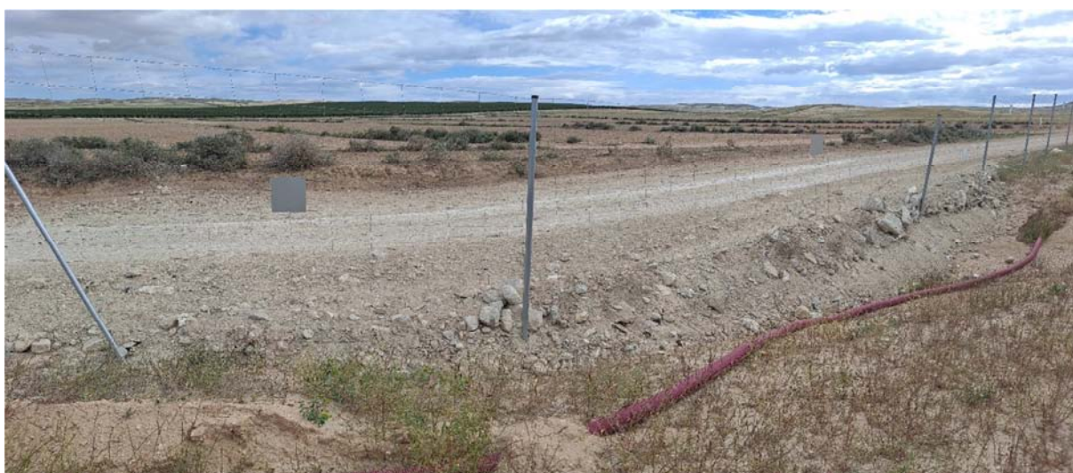
Figura 8.8. Paso inferior del vallado que continúa obstruido por los movimientos de tierra
