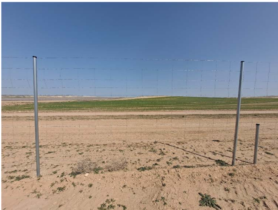
Figura 8.1. Ausencia de una placa de visibilidad en un vano del límite norte del vallado de la planta “Épila 3”
