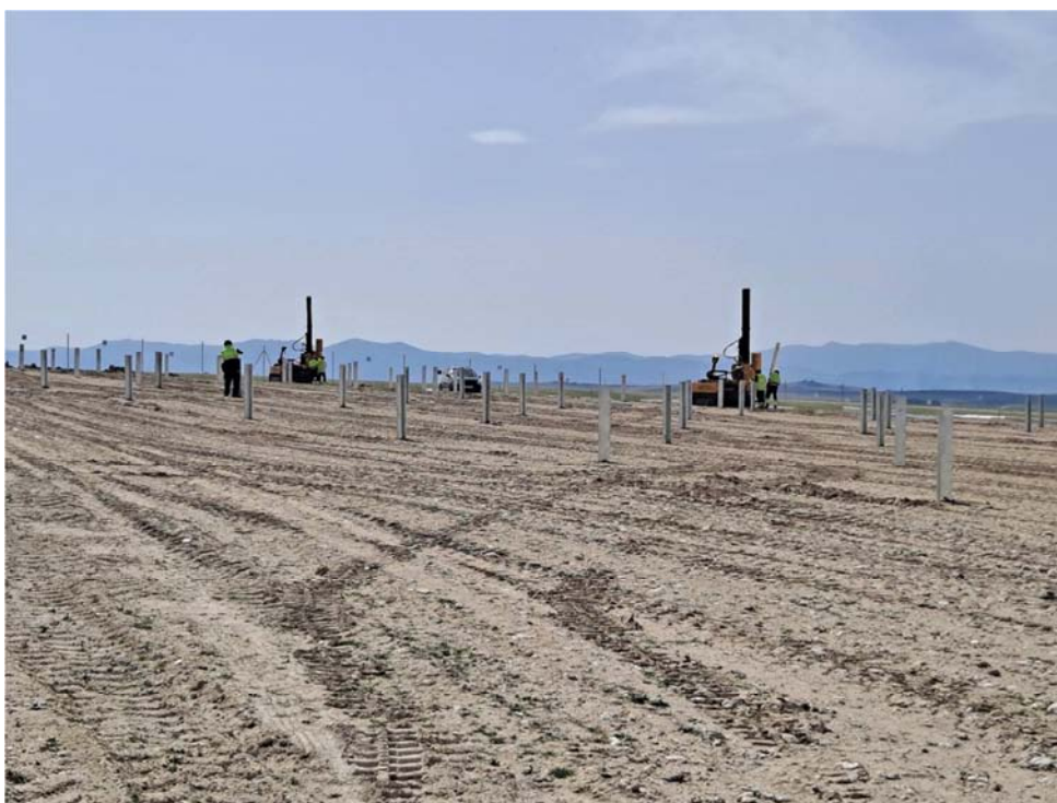
Figura 4.1. Trabajos de hincada de los postes verticales en la planta “Épila 2A”
