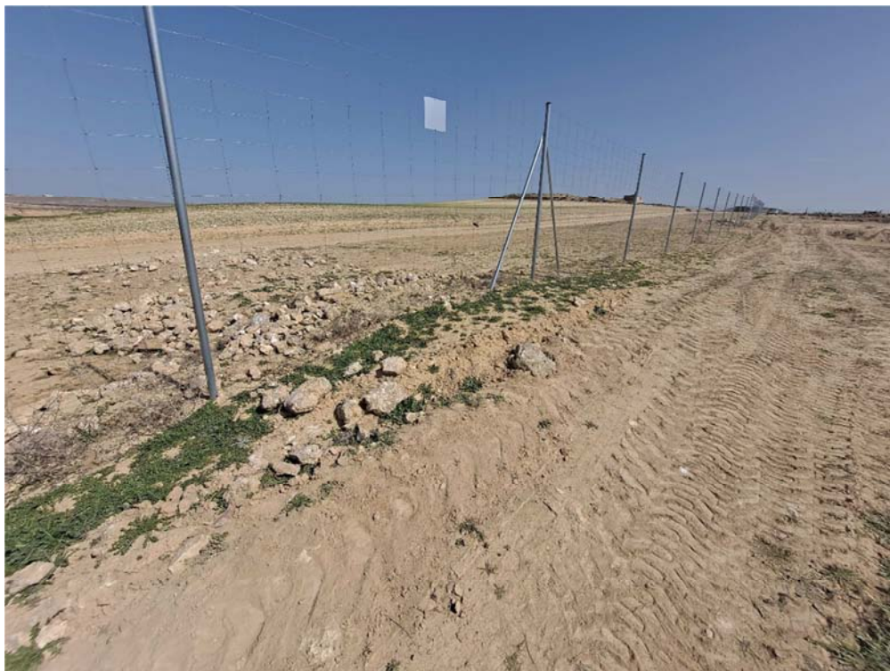
Figura 8.5. Obstrucción puntual del paso inferior del vallado en la planta “Épila 2B”
