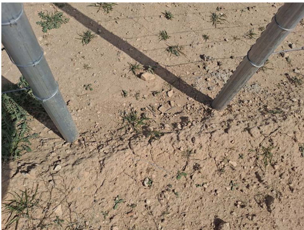
Figura 8.2. Alambres en el suelo en los pasos de fauna, en la planta “Épila 3”, aunque también se han identificado en las plantas “Épila 2A” y “Épila 2B”
