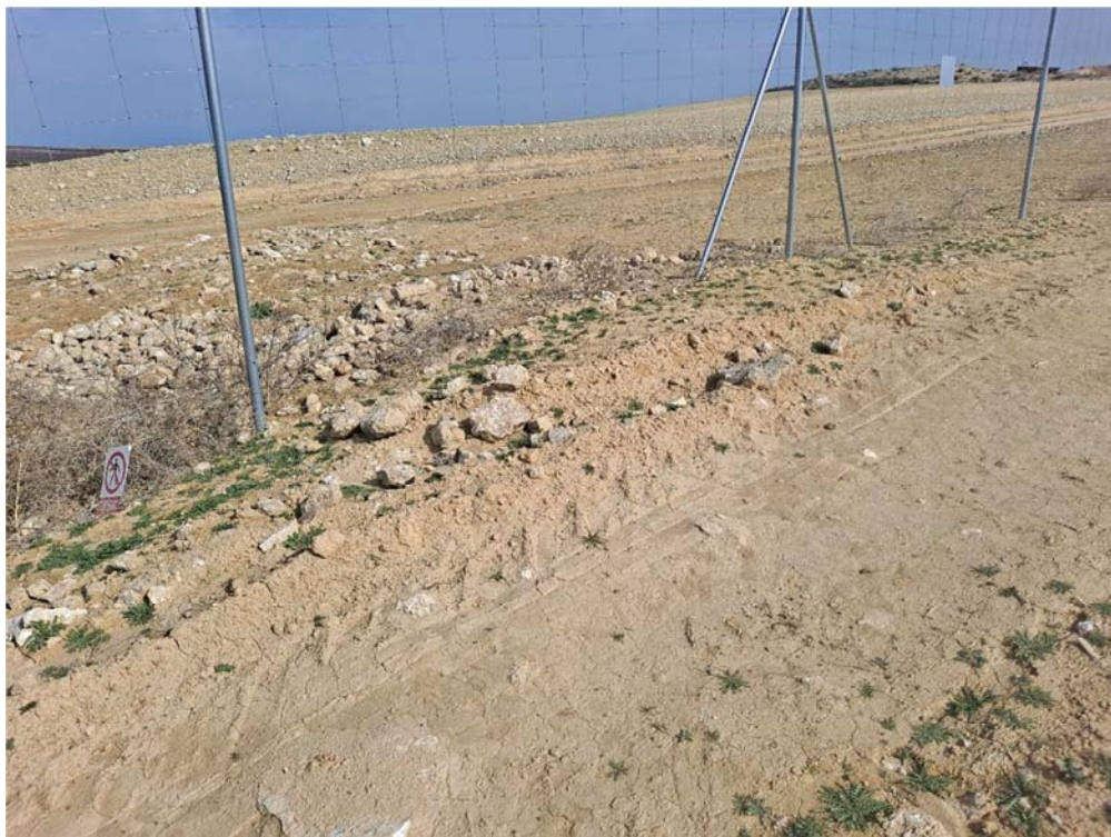
Figura 8.5. Obstrucción puntual del paso inferior del vallado en la planta “Épila 2B”
