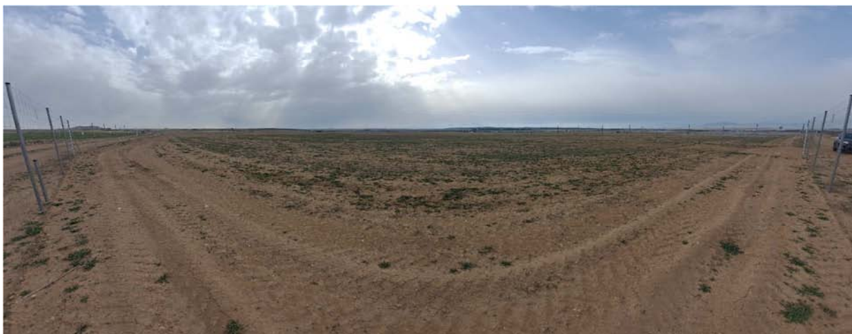
Figura 8.1. Aspecto de la planta “Épila 3” a fecha 15-02-24
