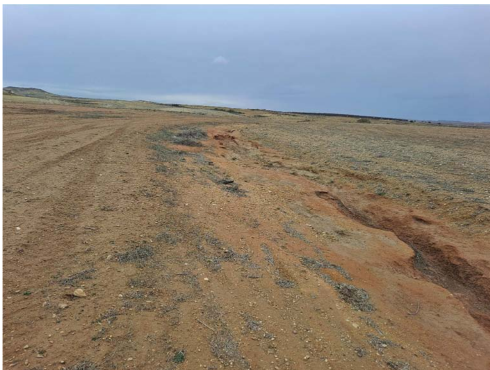
Figura 8.2. Cauce que atraviesa la planta “Épila 3”, que presenta erosión activa
