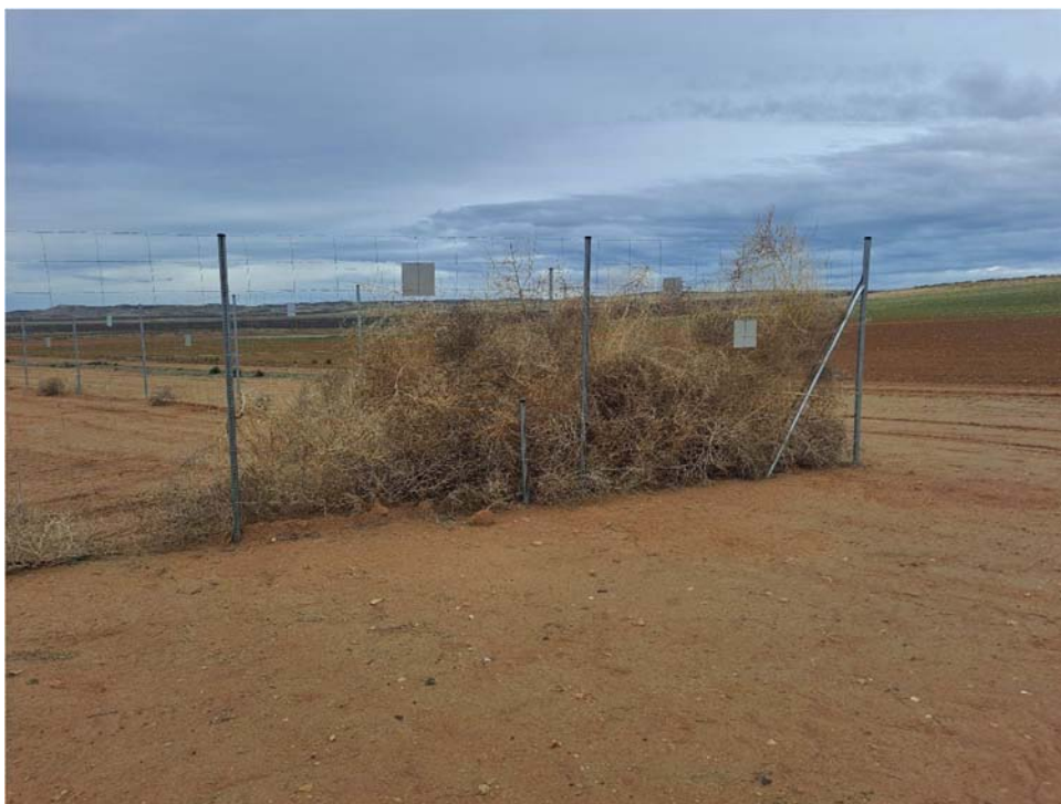
Figura 8.3. Vegetación obstruyendo parcialmente el vallado en la planta “Épila 3”
