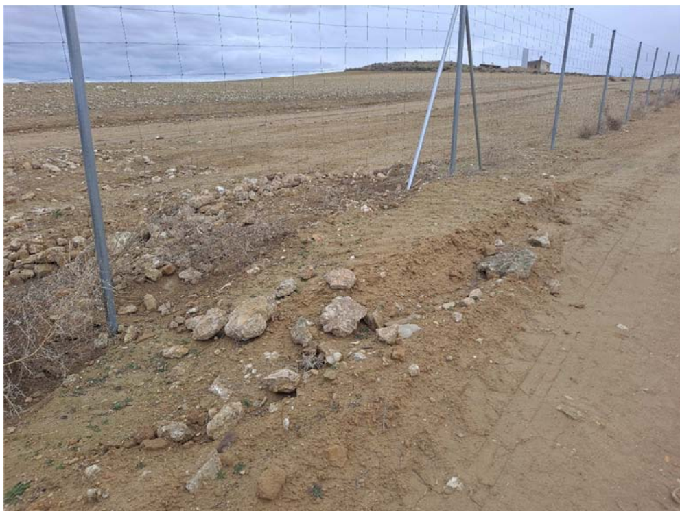
Figura 8.6. Obstrucción del paso inferior del vallado, en el extremo norte del primer ribazo de la planta “Épila 2B”
