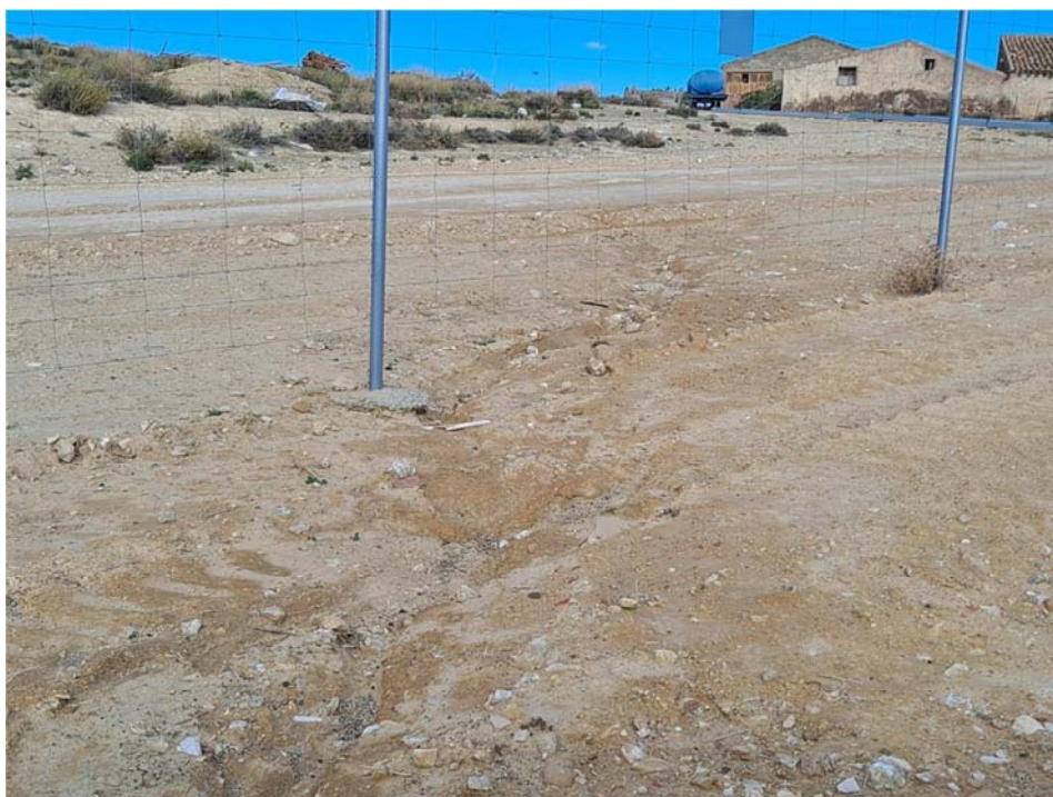
Figura 8.6. Pequeño reguero en el límite norte de la planta “Épila 2B” que ha producido un descalce de uno de los postes del vallado
