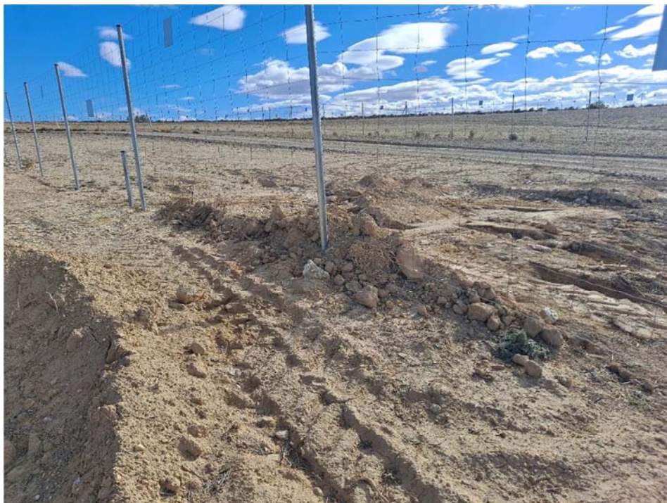
Figura 8.9. Punto de obstrucción del paso inferior del vallado, en el extremo sur del primer ribazo de la planta “Épila 2B”
