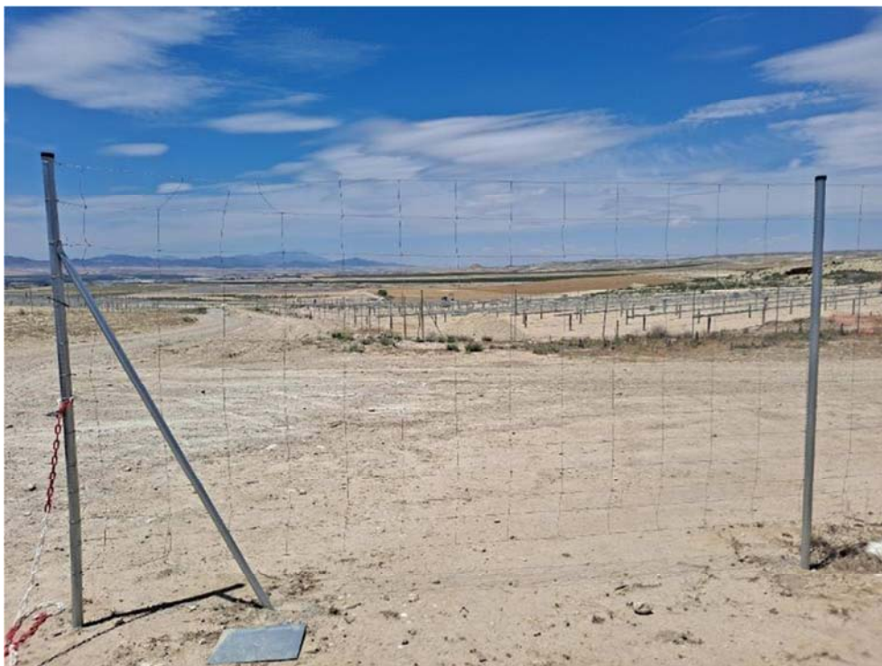
Figura 8.18. Placa de visibilidad caída en un tramo del vallado de “Épila 1”.
