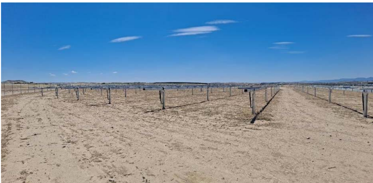
Figura 8.1. Aspecto de la planta “Épila 3”. No se han realizado nuevos trabajos en la misma
