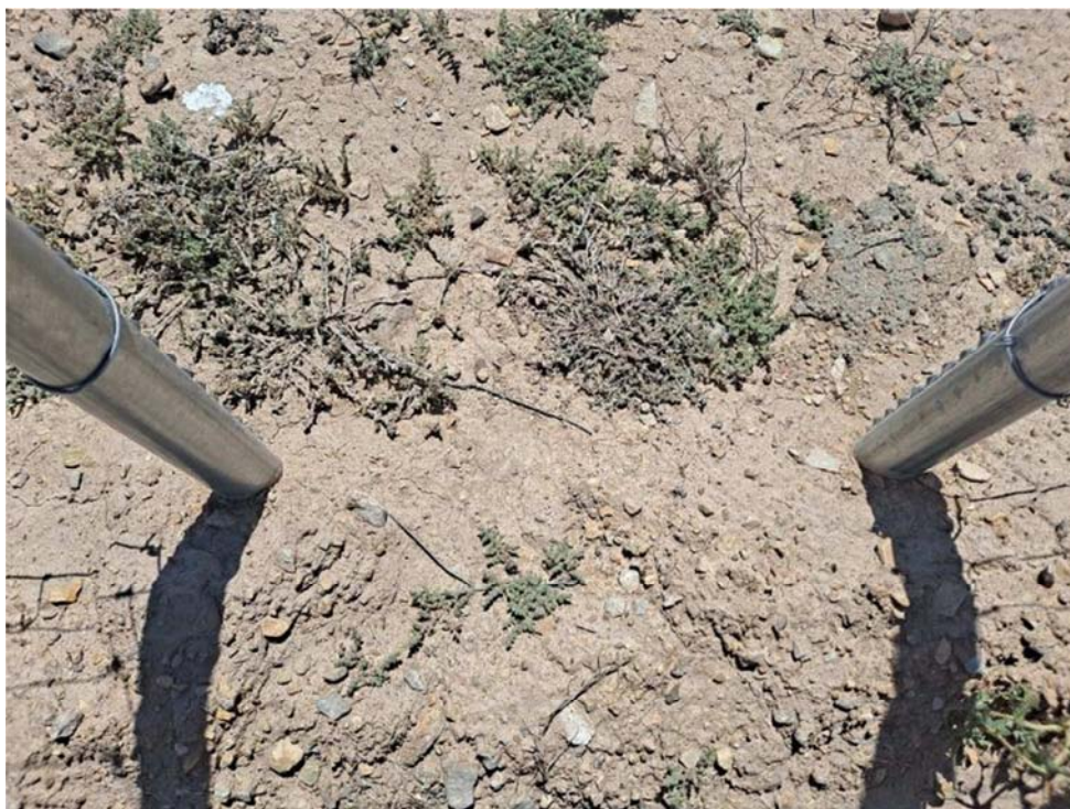
Figura 8.4. Alambres en el suelo en los pasos de fauna en la planta “Épila 3”, aunque también se han identificado en las plantas “Épila 2A” y “Épila 2B”
