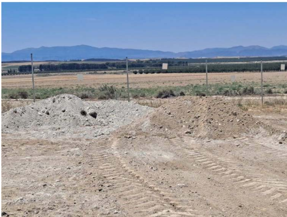
Figura 8.8. Acopios de tierras y tierra vegetal procedentes de los movimientos de tierra. Presentan alturas de 1 m
