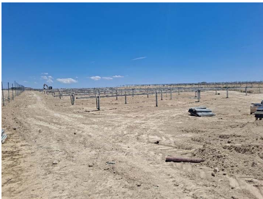
Figura 4.1. Ribazos suavizados, postes verticales hincados y seguidores colocados en la planta “Épila 2B”
