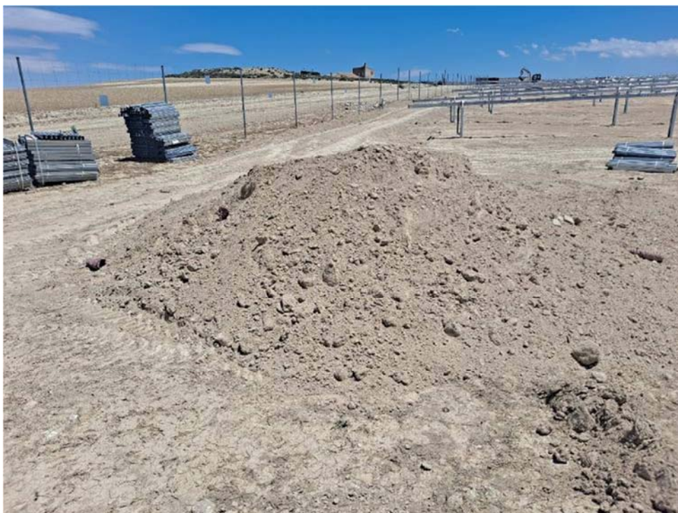
Figura 8.14. Posible acopio de tierra vegetal, de 1 m de altura, procedente del suavizado de los ribazos en “Épila 2B”
