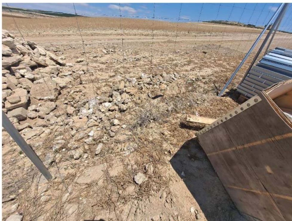
Figura 8.10. Paso inferior del vallado obstruido en la planta “Épila 2B”
