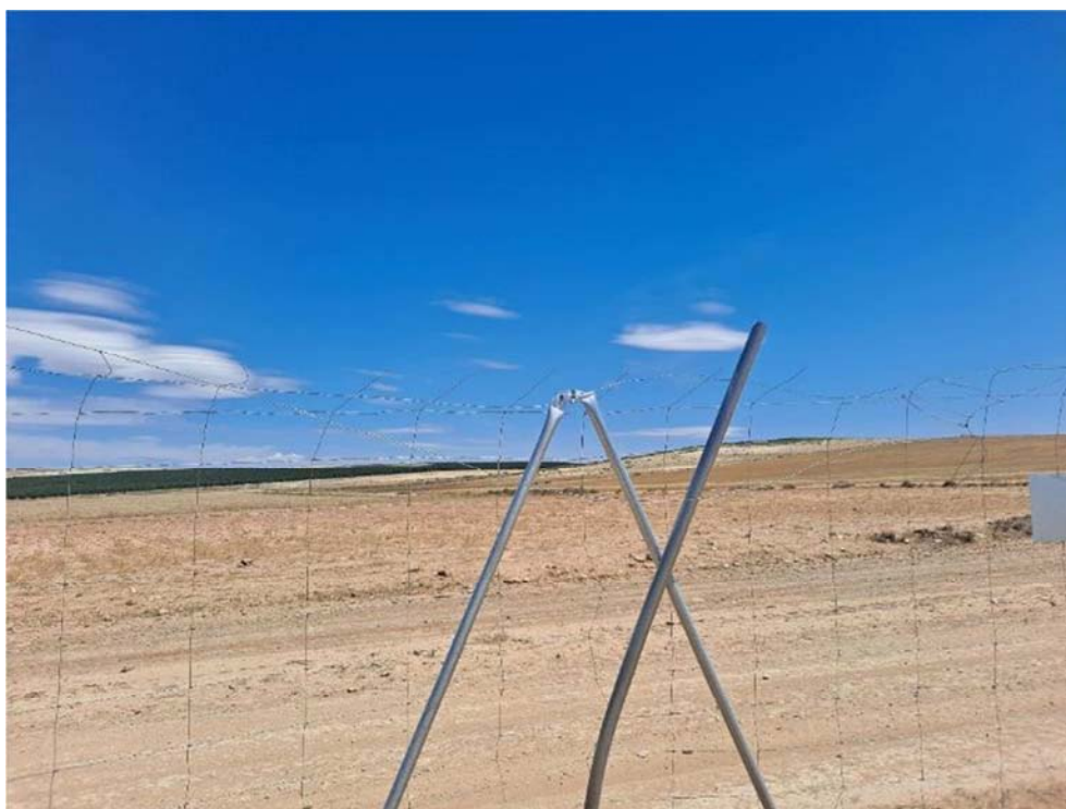
Figura 8.3. Tramo del vallado roto, con elementos punzantes peligrosos para la fauna, en “Épila 3”
