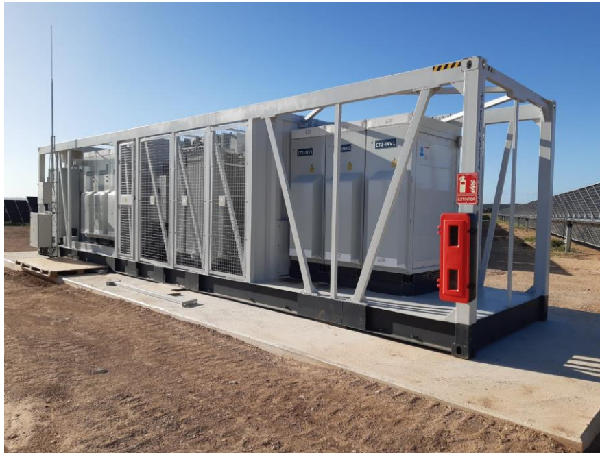
Figura 1. Instalación de extintor en el Centro de Transformación.
