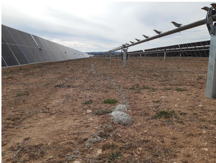
Figura 2. Residuos de hormigón observados en el noreste de la planta.
