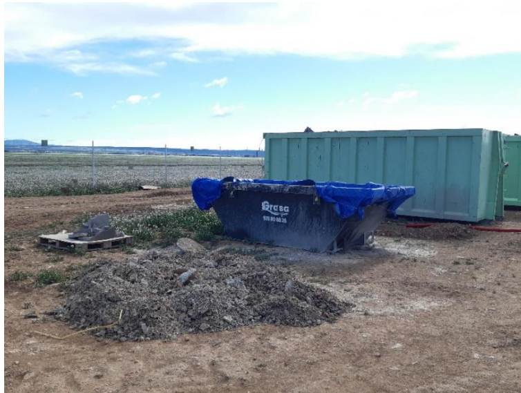
Figura 1. Residuos de hormigón fuera de su contenedor correspondiente.
