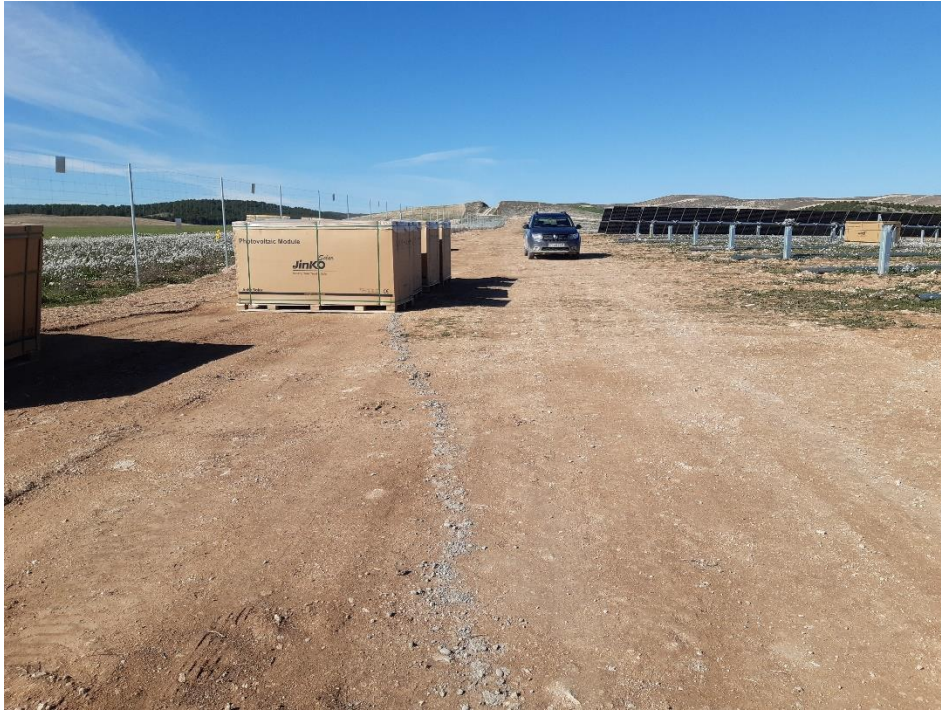
Figura 3. Restos de hormigón sin limpiar en la zona sur de la planta.
