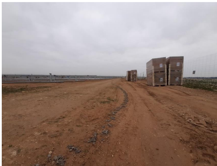
Figura 2. Residuos de hormigón encontrados en la zona sur de la implantación.
