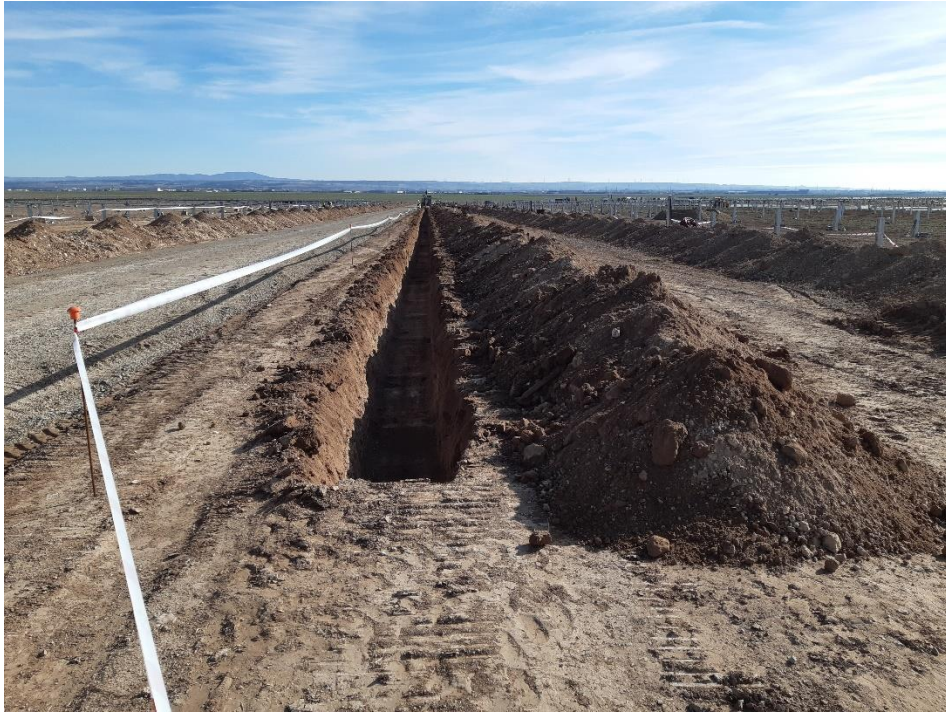
Figura 3. Acopio de tierra vegetal y áridos de forma incorrecta en la zanja de evacuación del interior de la implantación.
