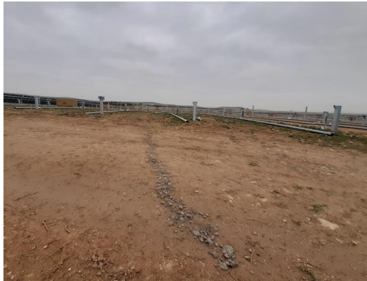
Figura 1. Restos hormigón en el suelo de la planta.
