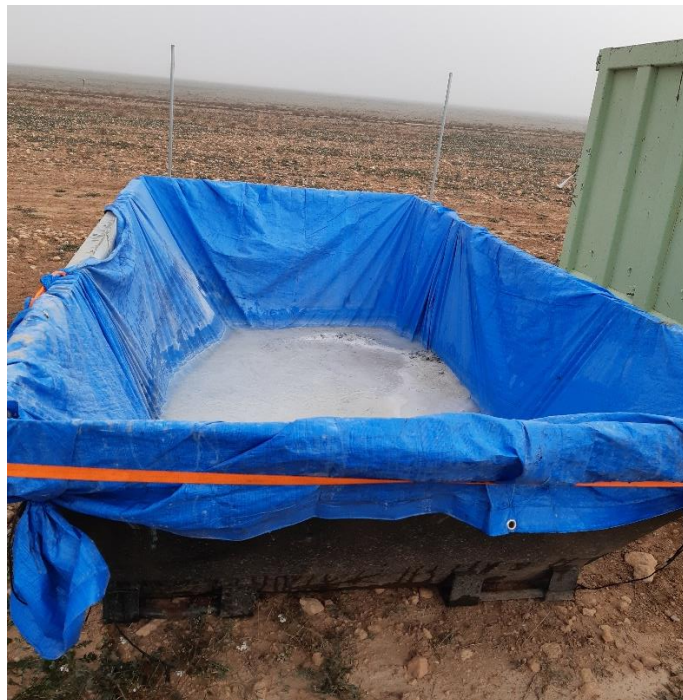
Figura 3. Depósito correspondiente para el lavado de hormigón.
