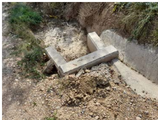
Fig. 1 Red drenaje y arqueta de hormigón exterior a la planta.
