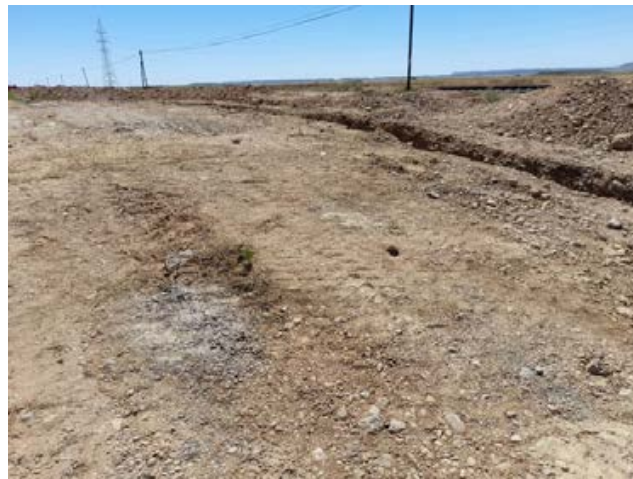
Fig. 1. Derrame de tortas de hormigón.
