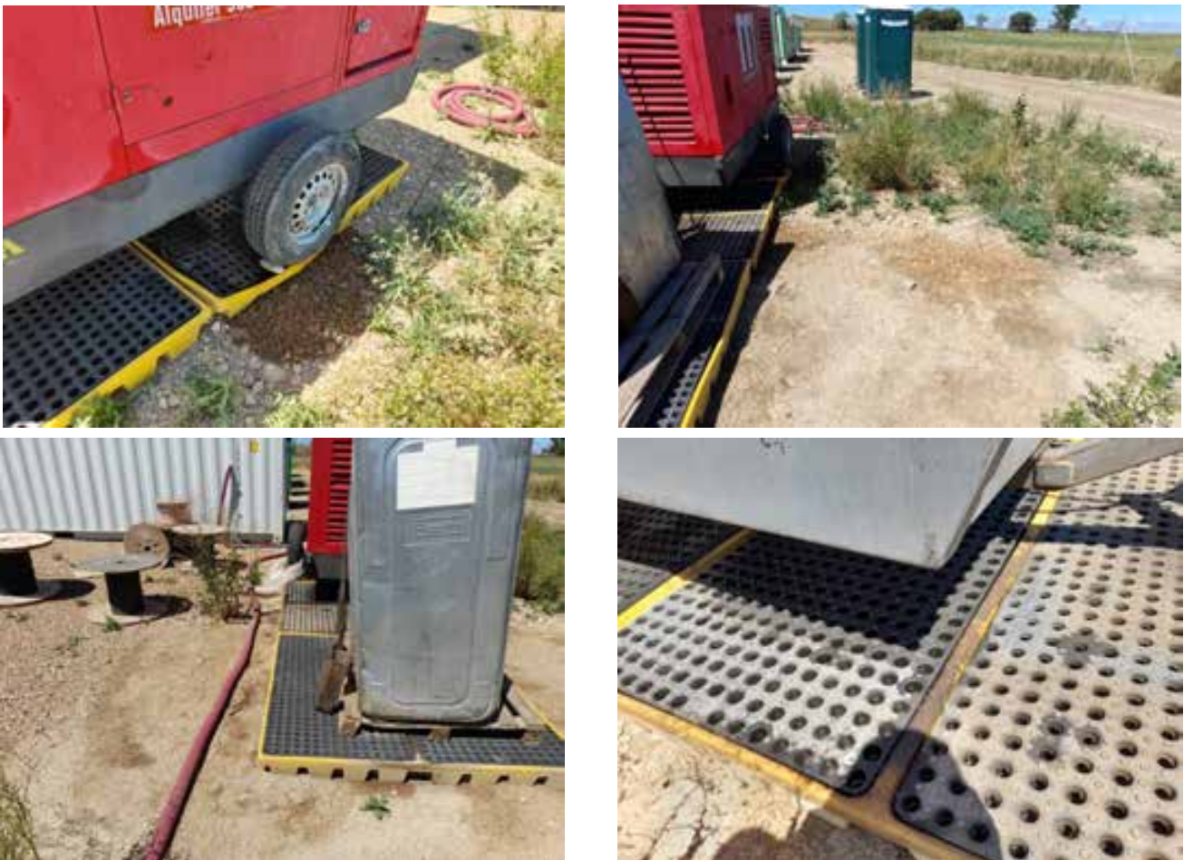
Fig. 1. Derrame del cubeto de retención del generador.
