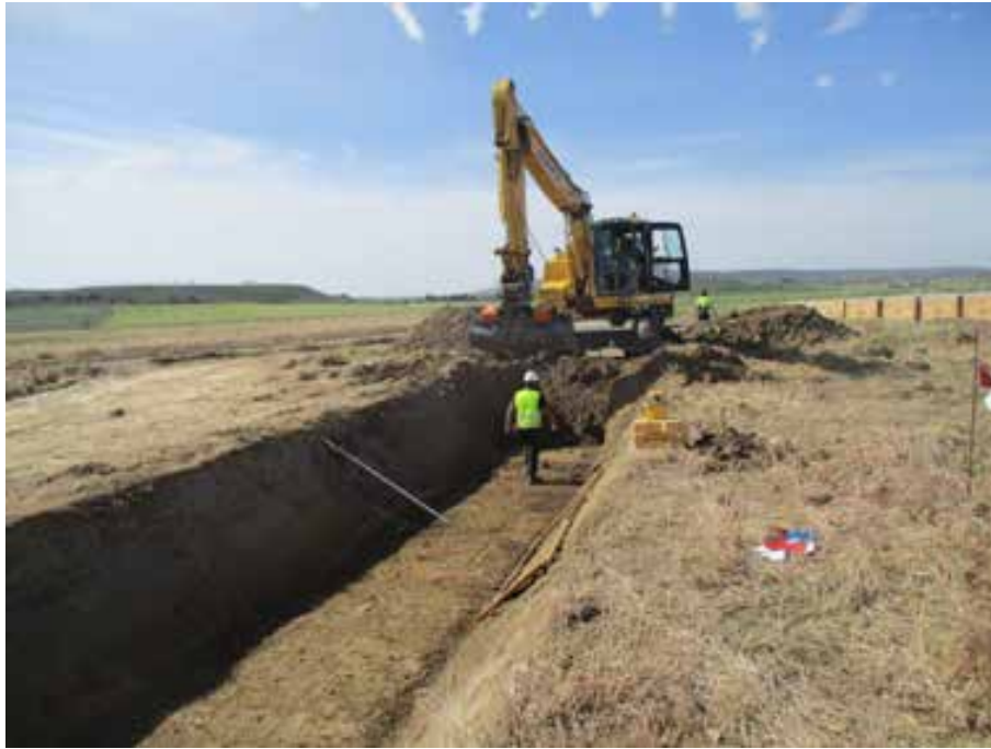
Fig. 1. Zanja del canal principal de drenaje. Parcela E. Vista general desde E.
