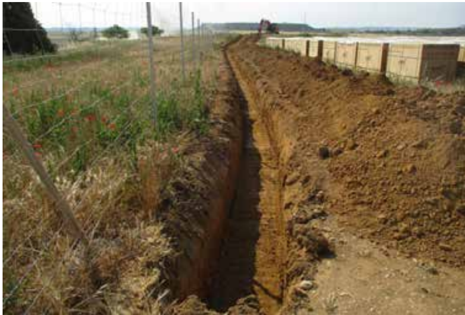
Fig. 1. CyS de la excavación de la zanja. Lateral E de la parcela W.
