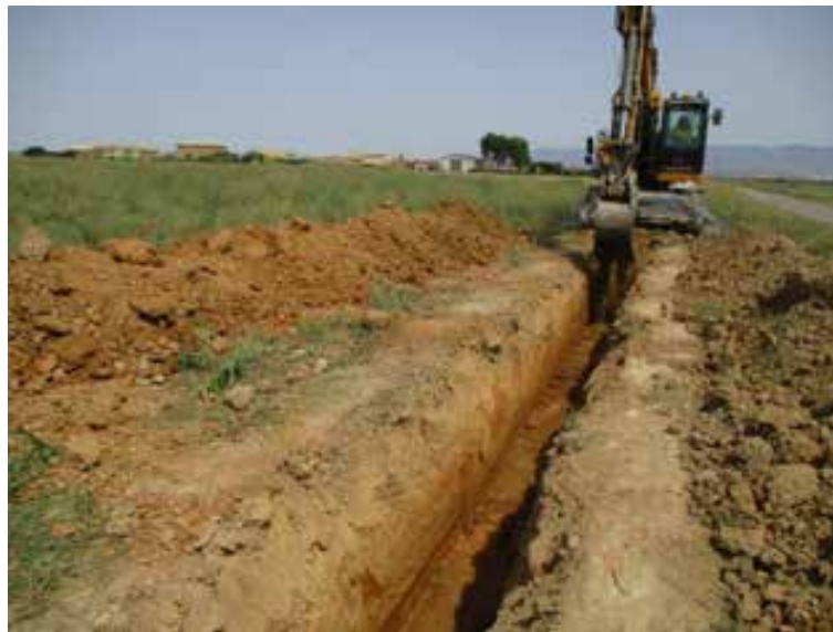
Fig. 1. Supervisión de los trabajos de excavación de la zanja para la línea de evacuación.
