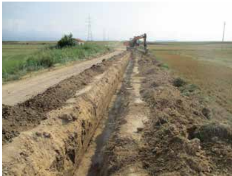
Fig. 1. Supervisión de los trabajos de excavación de la zanja para la línea de evacuación.
