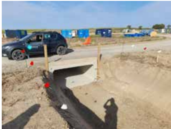
Fig. 1 Intersección del vial principal por encima del drenaje interior de la planta.
