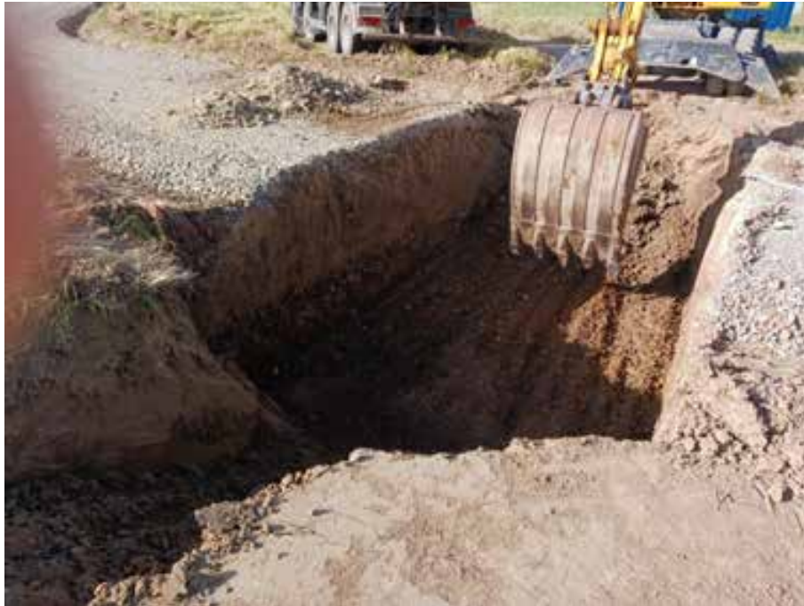
Fig. 2. Zanja del canal lateral de drenaje (tramo 1). Parcela E. Proceso de excavación y perfil estratigráfico (limos sobre gravas)
