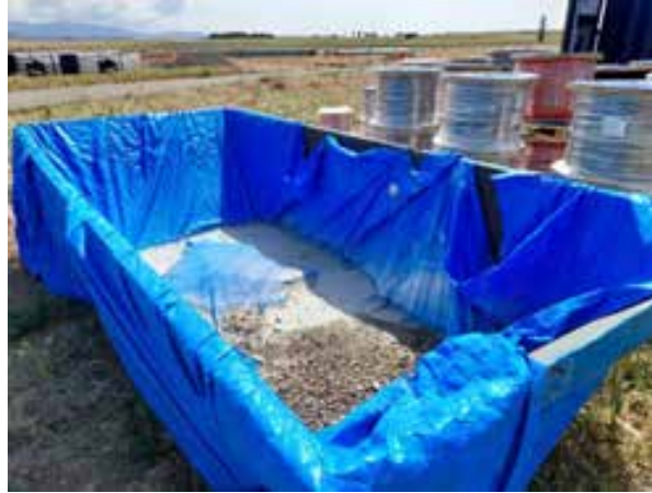
Fig. 3. Contenedor de residuos de hormigón
