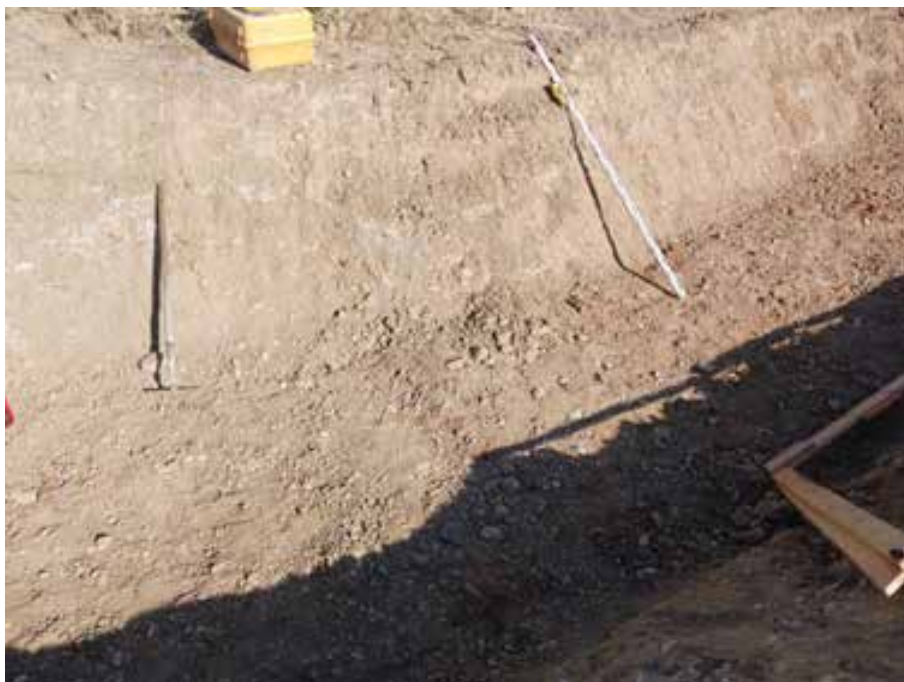
Fig. 4. Zanja del canal principal de drenaje. Parcela E. Detalle de composición estratigráfica del terreno. Depositos de colmatación sobre afloramiento de mallacán compacto.
