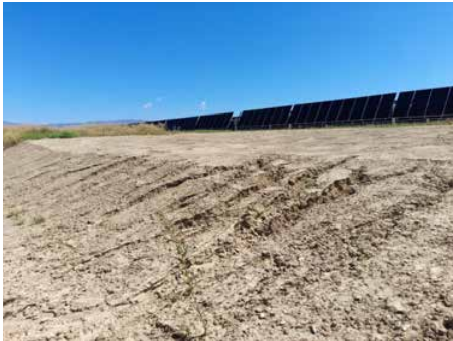
Fig. 1 Erosión hídrica en talud oeste de la planta.
