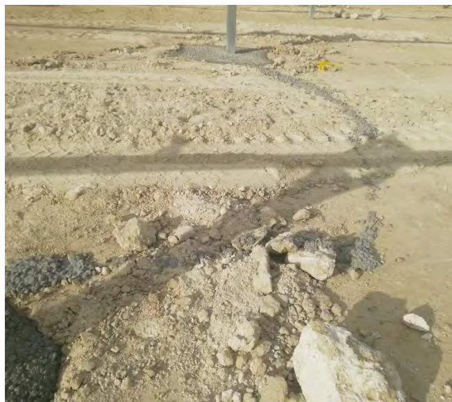
Figura 2: Restos de hormigón entre las hincas.
