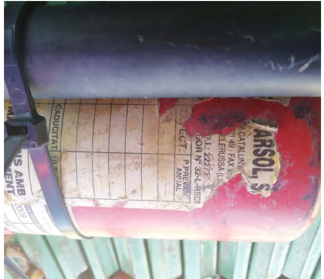
Figura 2: Extintor sin presión y sin revisiones.
