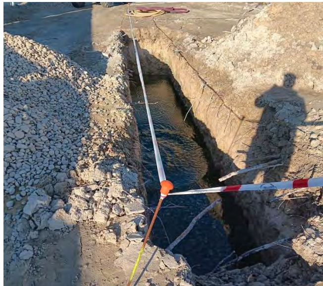
Figura 1: Acumulación de agua en cata tomada
