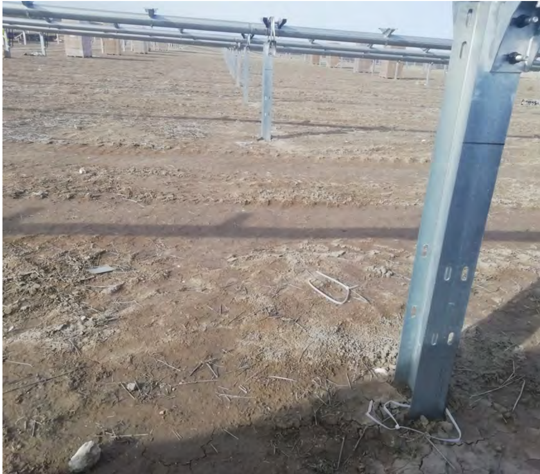
Figura 1: Restos de bridas entre los seguidores.
