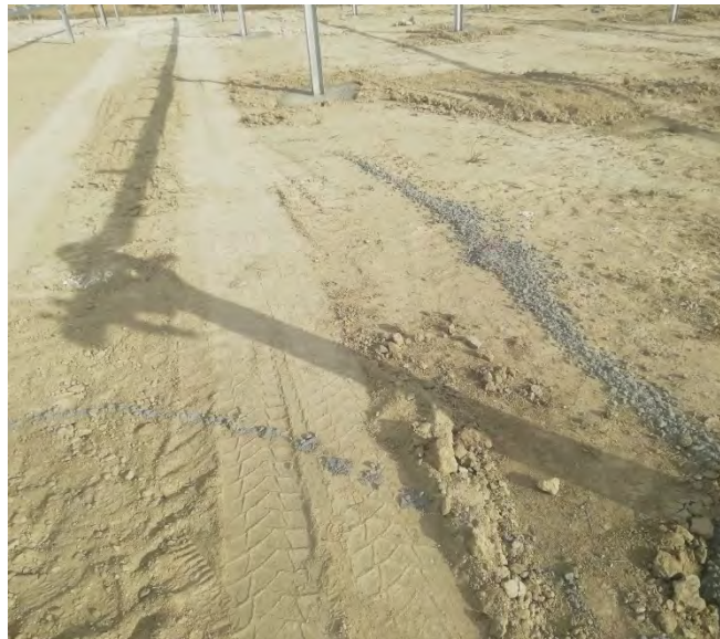
Figura 1: Restos de hormigón entre las hincas.
