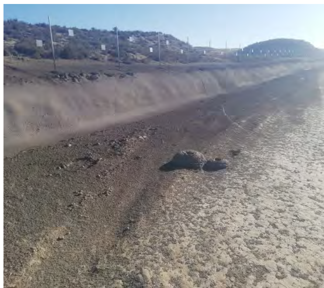
Figura 2: Restos del gunitado.
