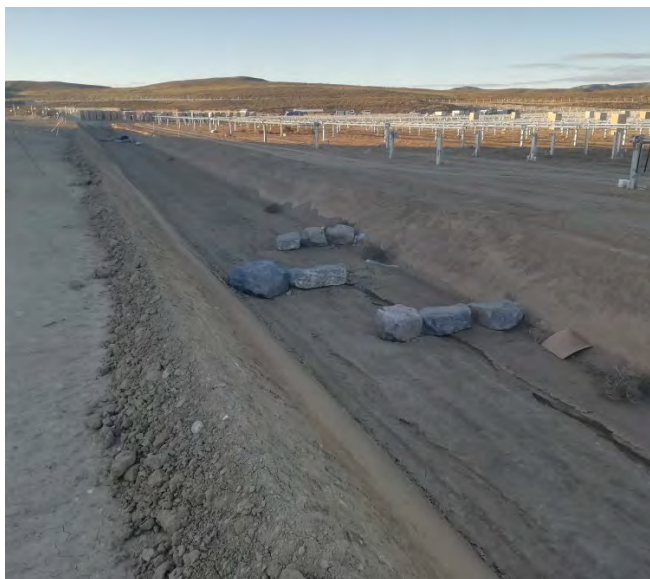
Figura 2: Piedras colocadas en diversos puntos de la cuneta.
