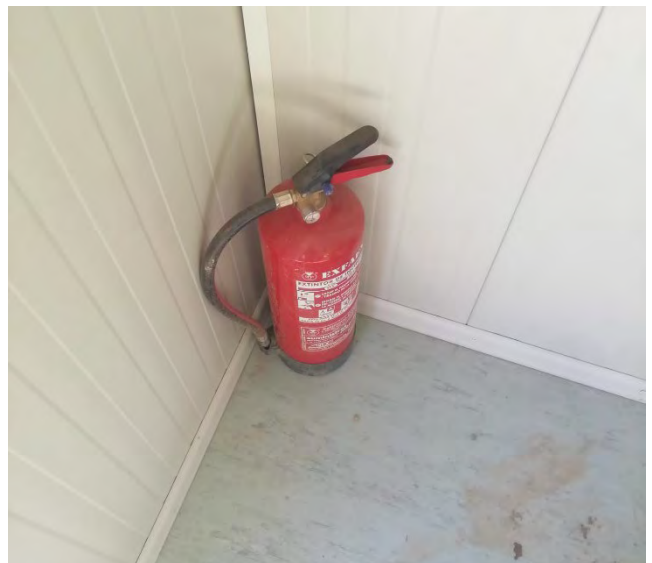
Figura 4: Extintor en caseta a la entrada de la planta.
