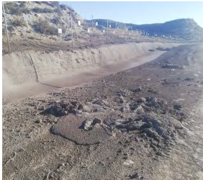
Figura 1: Restos del gunitado.
