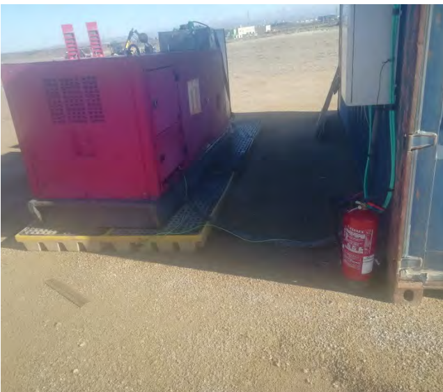
Figura 3: Extintor en grupo electrógeno en casetas.
