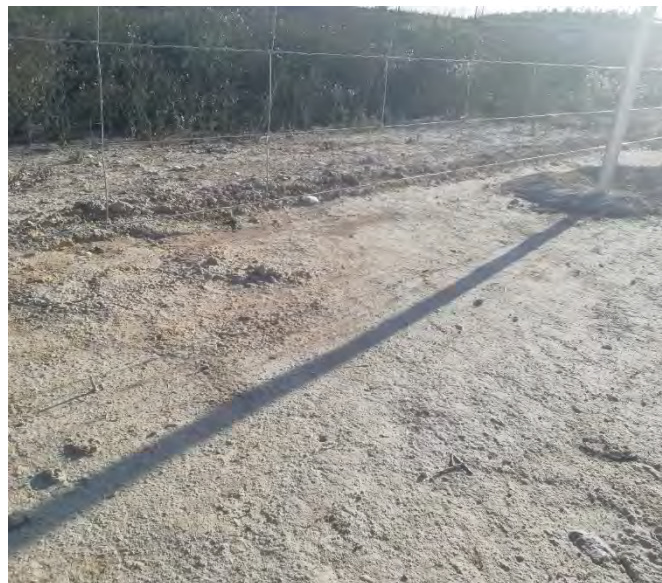
Figura 2: Vallado separado del suelo.
