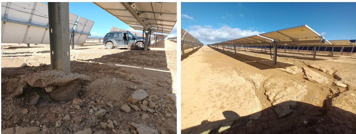
Algunos procesos erosivos identificados en el mes de febrero.
