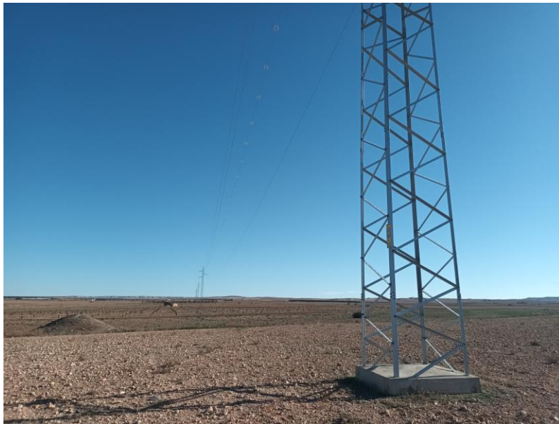
Imagen perteneciente a la línea de alta tensión SET Calatayud – SET La Almunia, durante la visita del pasado mes de noviembre.
