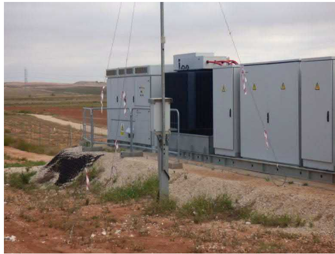
Imagen 5. Tiras de cinta de balizamiento instaladas en los cables de las torres anemométricas.
