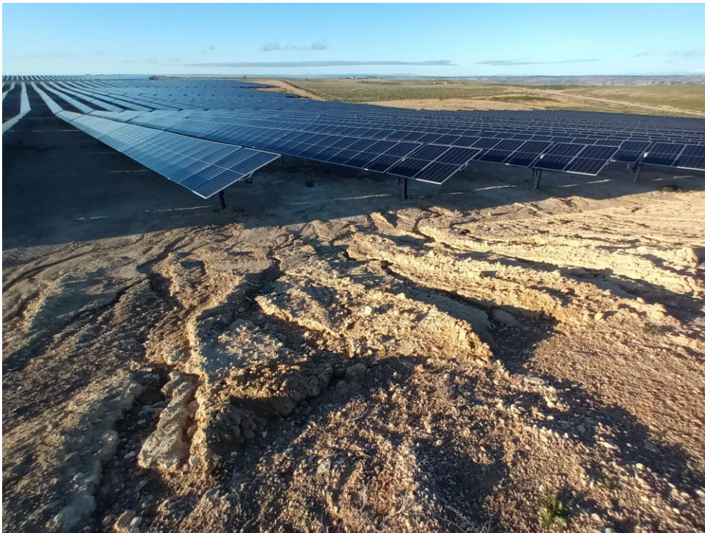
Arriba y abajo, diferentes puntos de vista de las erosiones en el talud referido.
