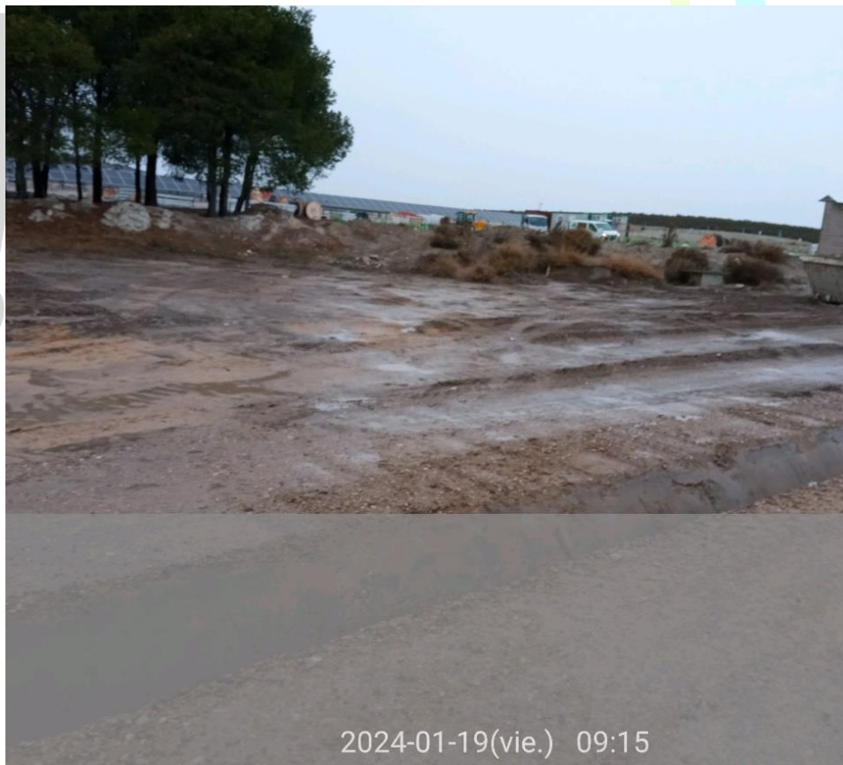
Ilustración 31: zona en la que se ubicaba la piscina de hormigón corregida adecuadamente
