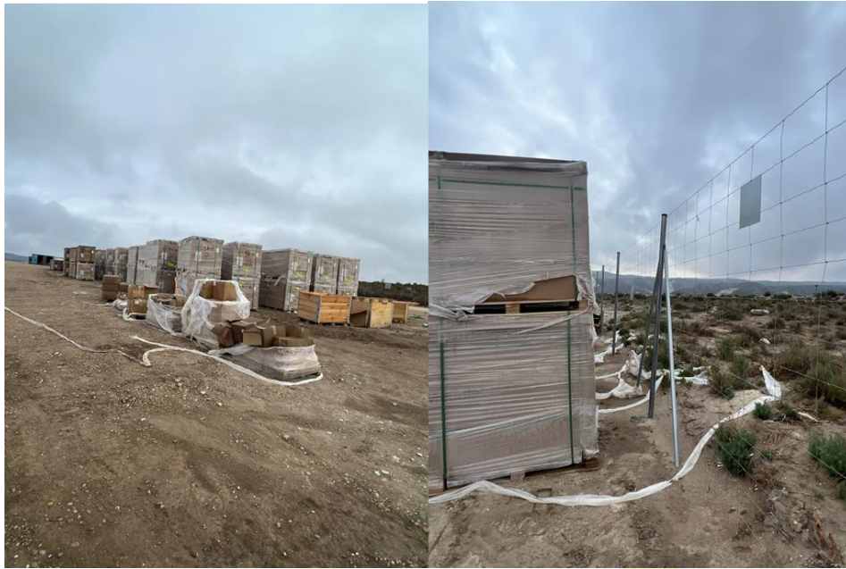
Ilustración 16: residuos no peligrosos (plásticos) sin gestionar sobre vegetación natural y acopio material obra dentro del vallado
