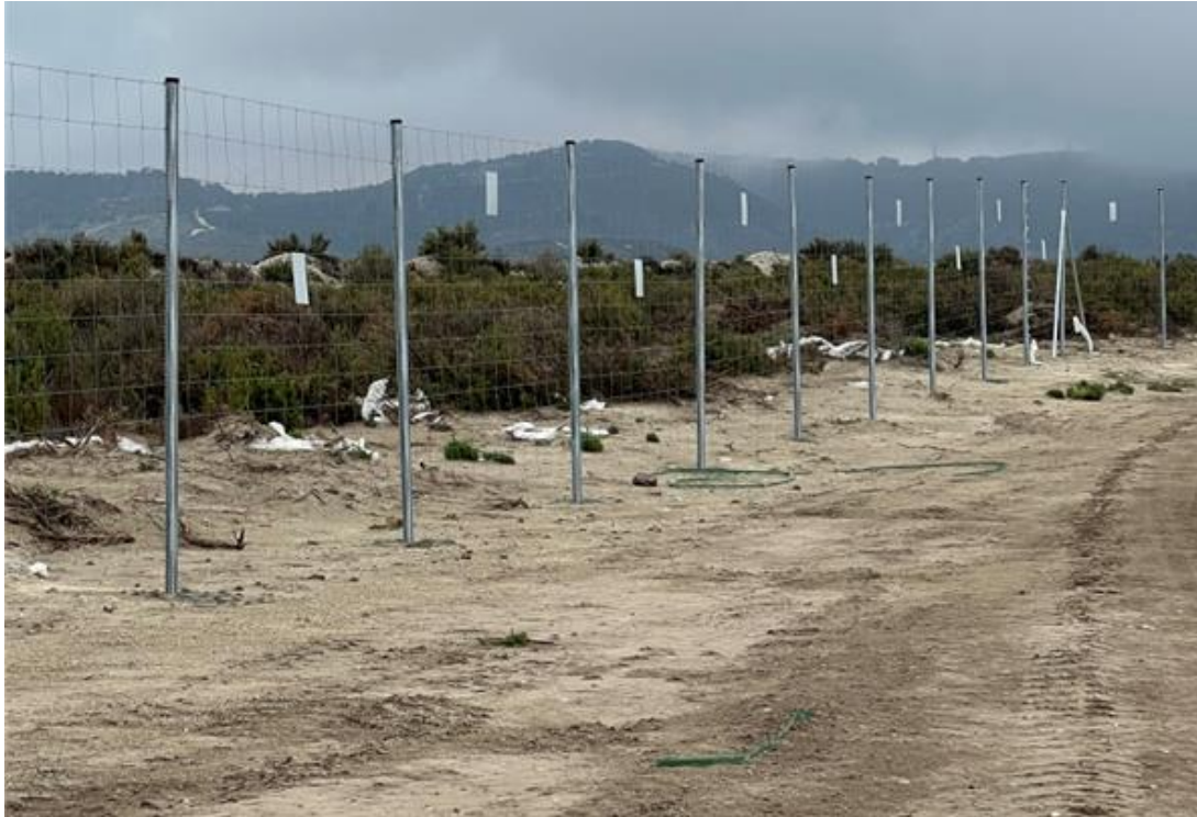
Ilustración 14: placas anticolisión bien colocadas y residuos no peligrosos (plásticos) sin gestionar sobre vegetación natural
